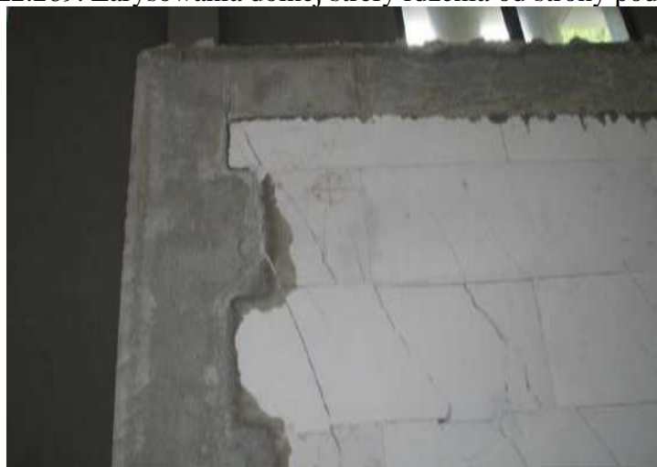
Rys. Z2.270. Pionowa rysa w górnym narożu łączącym poziomy rygiel i rdzeń od strony podpory B
