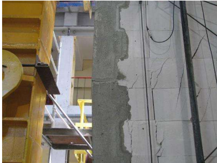
Rys. Z2.249. Poziome zarysowanie żelbetowego rdzenia w połowie wysokości od strony podpory B
