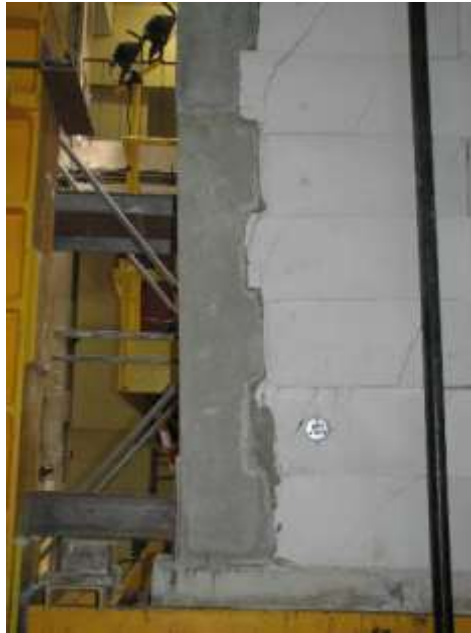
Rys.Z2.18. Zarysowania muru na styku z żelbetowym rdzeniem oraz zarysowania rdzenia od strony podpory B
