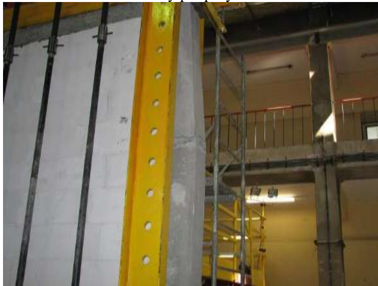
Rys.Z2. 32. Zarysowania rdzenia od strony podpory A
