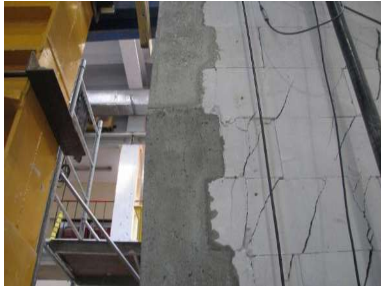
Rys. Z2.215. Poziome zarysowanie żelbetowego rdzenia w połowie wysokości od strony podpory B
