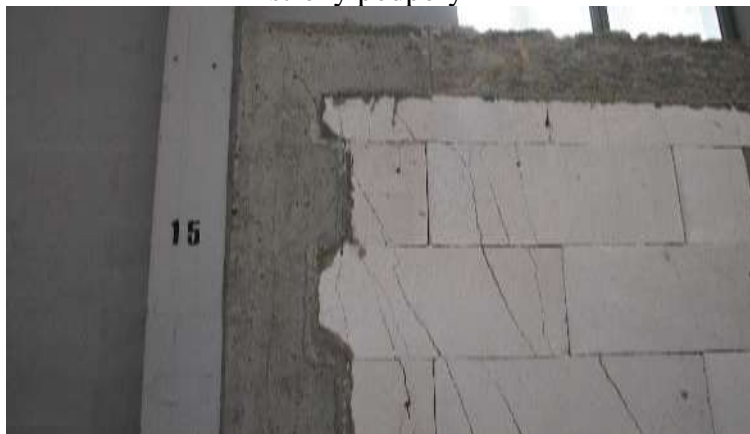
Rys. Z2.234. Ukośne rysy w górnym narożu łączącym poziomy rygiel i rdzeń od strony podpory B
