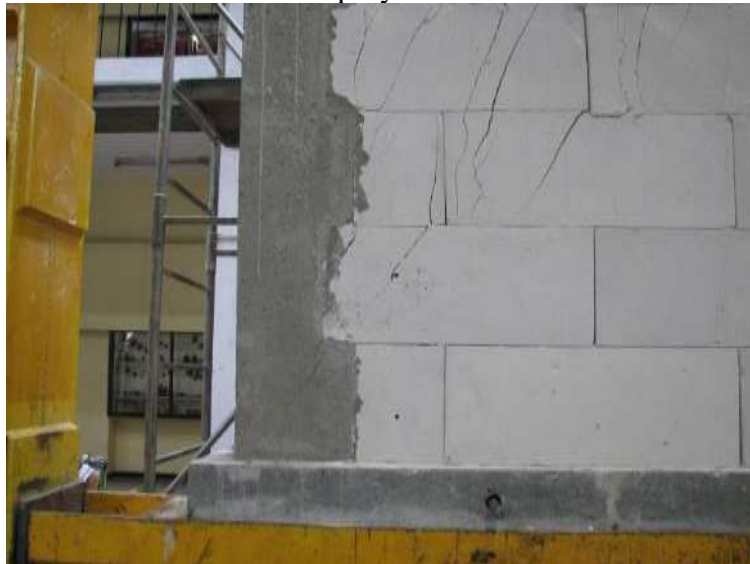
Rys. Z2.233. Poziome zarysowanie żelbetowego rdzenia w styku z poziomym rdzeniem od strony podpory B
