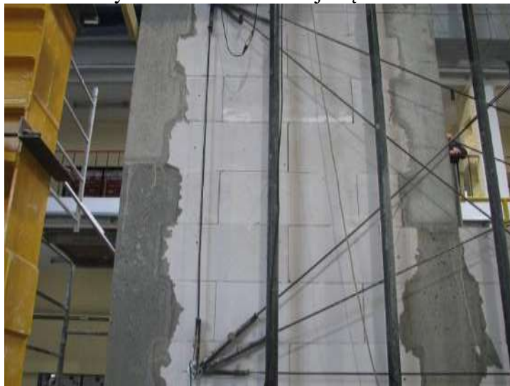
Rys. Z2.190. Zarysowania wtórne w filarku od strony podpory B
