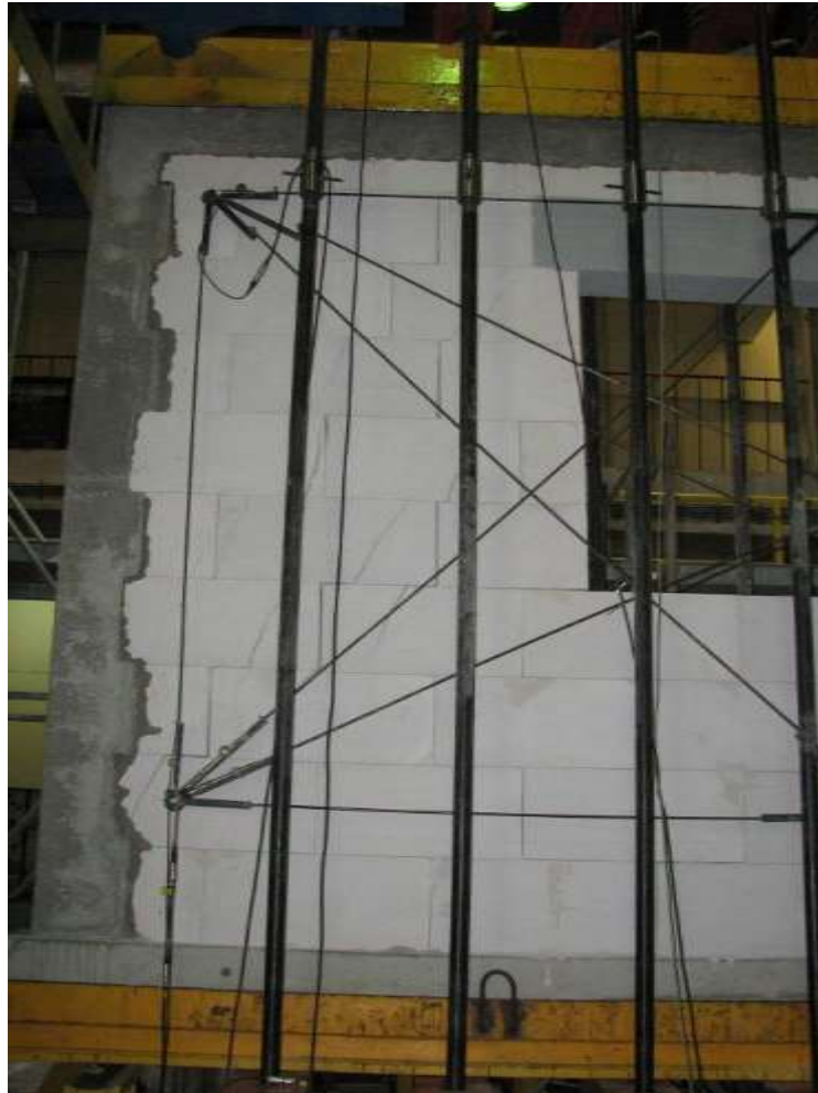
Rys. Z2.100. Zarysowania filarka od strony podpory B
