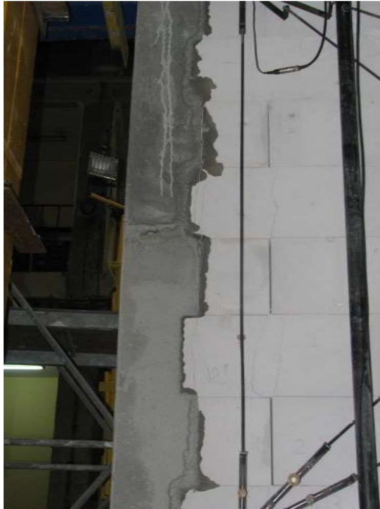
Rys. Z2.145. Poziome zarysowanie żelbetowego rdzenia w połowie wysokości od strony podpory B
