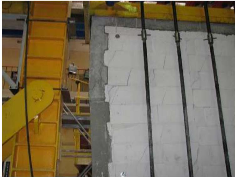
Rys.Z2. 31. Zarysowania muru na styku z żelbetowym rdzeniem oraz zarysowania rdzenia od strony podpory B
