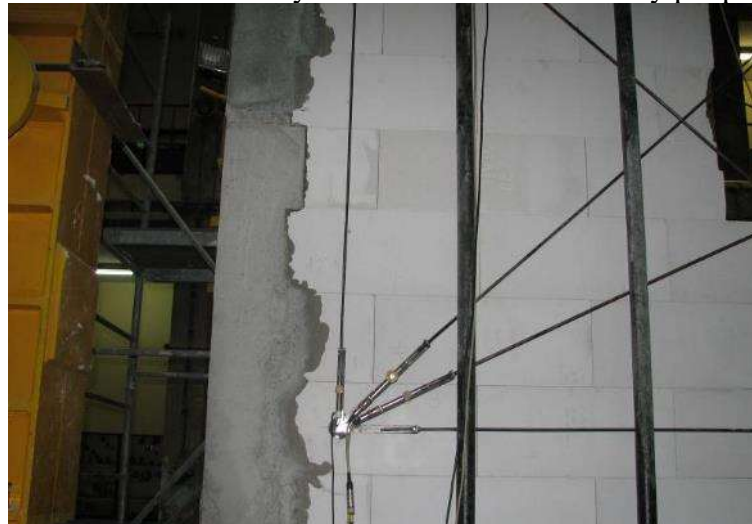
Rys. Z2.112. Wtórne zarysowania filarka od strony podpory B
