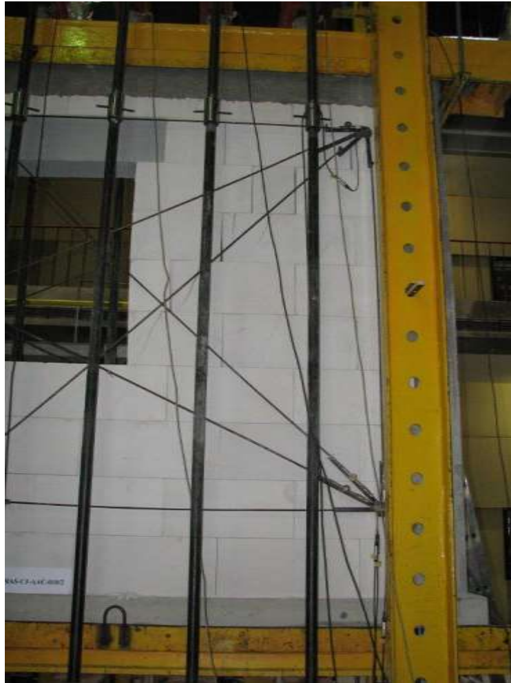
Rys. Z2.99. Zarysowania filarka od strony podpory A
