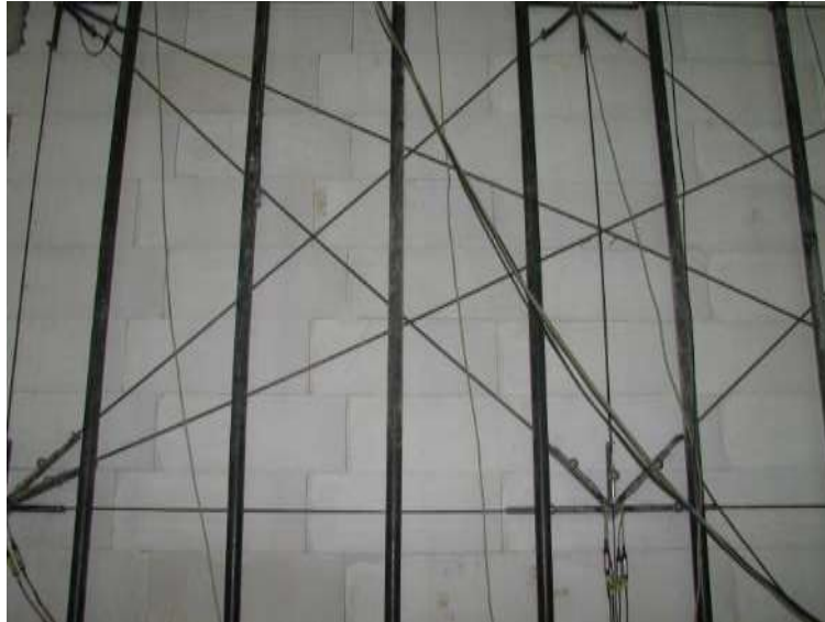
Rys.Z2.16. Wtórne zarysowania ściany
