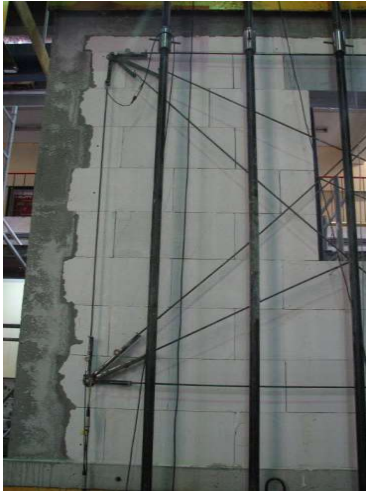
Rys. Z2.97. Wtórne zarysowania filarka od strony podpory B
