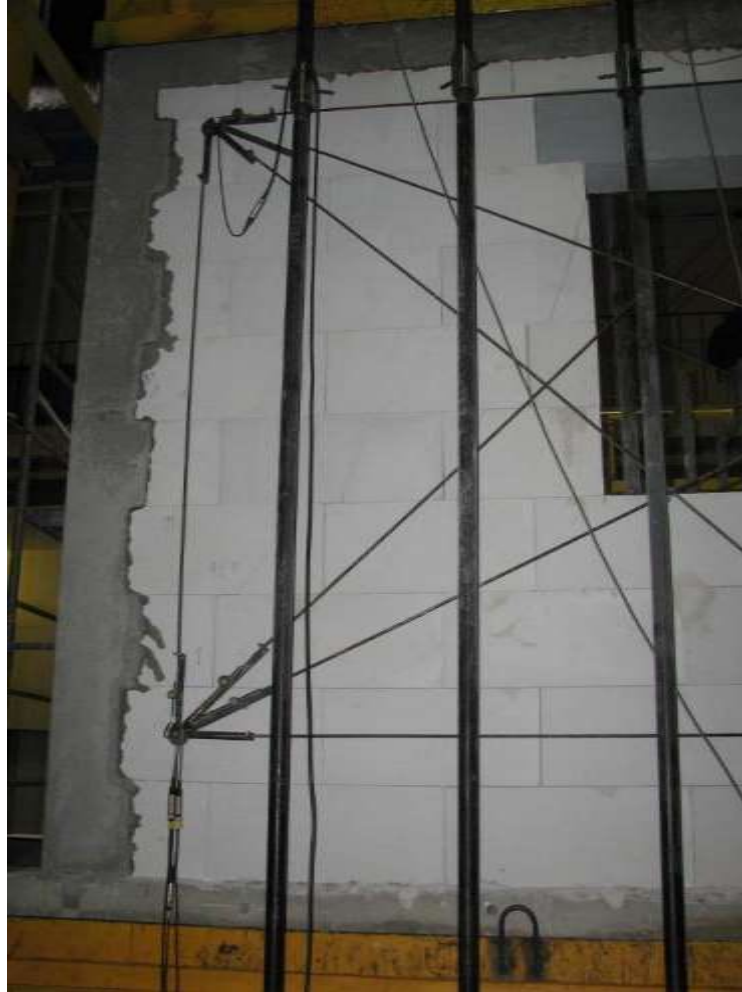
Rys. Z2.83. Wtórne zarysowania ściany w filarku nad podporą B
