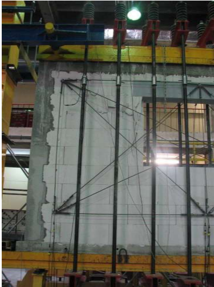
Rys. Z2.144. Zmiażdżenie górnego obszaru muru od strony podpory B
