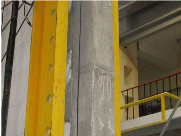
Rys. Z2.232. Poziome zarysowanie żelbetowego rdzenia w połowie wysokości od strony podpory B
