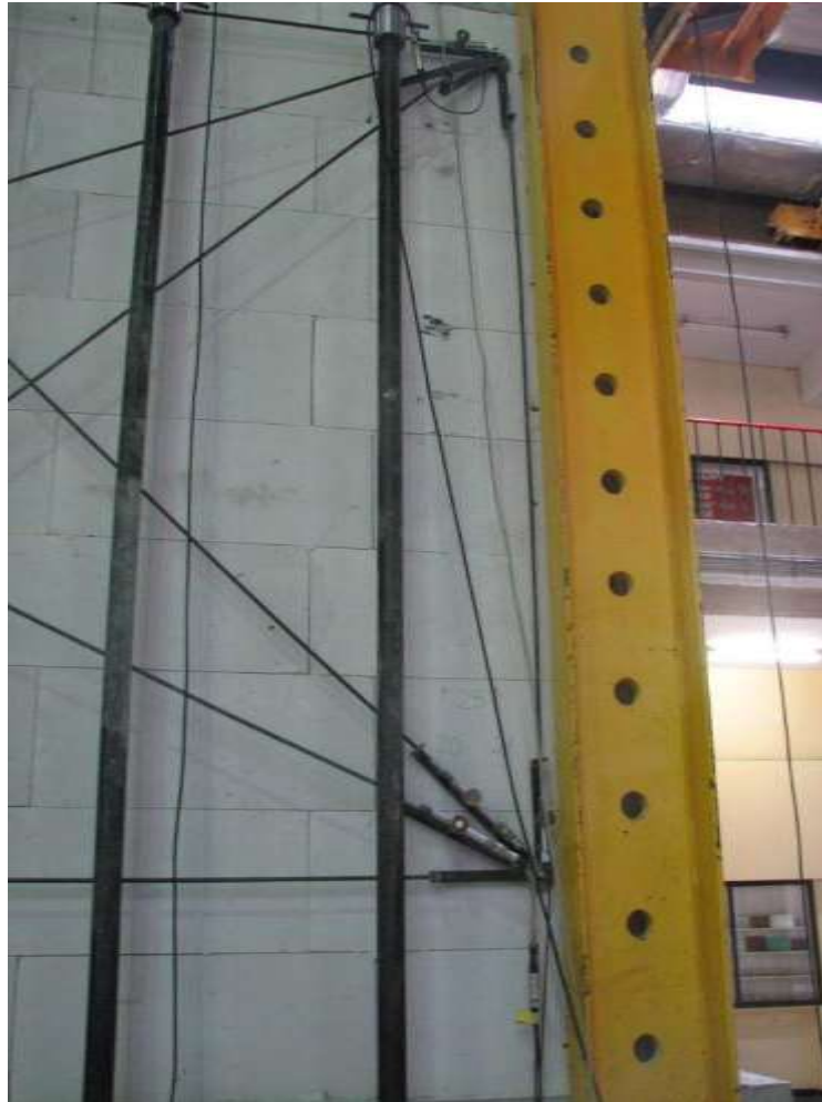
Rys.Z2. 29. Wtórne zarysowania ściany
