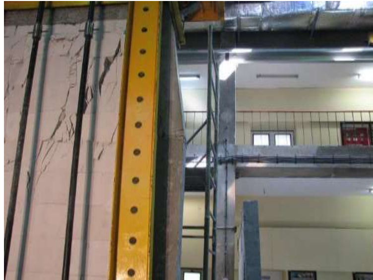
Rys.Z2. 46. Zarysowania górnej części rdzenia od strony podpory A
