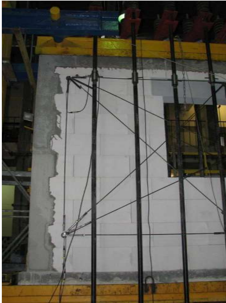
Rys. Z2.130. Zarysowania filarka od strony podpory B
