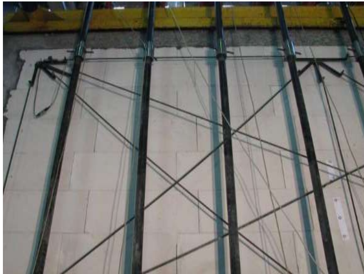
Rys.Z2. 40. Pierwsze zarysowania ściany
