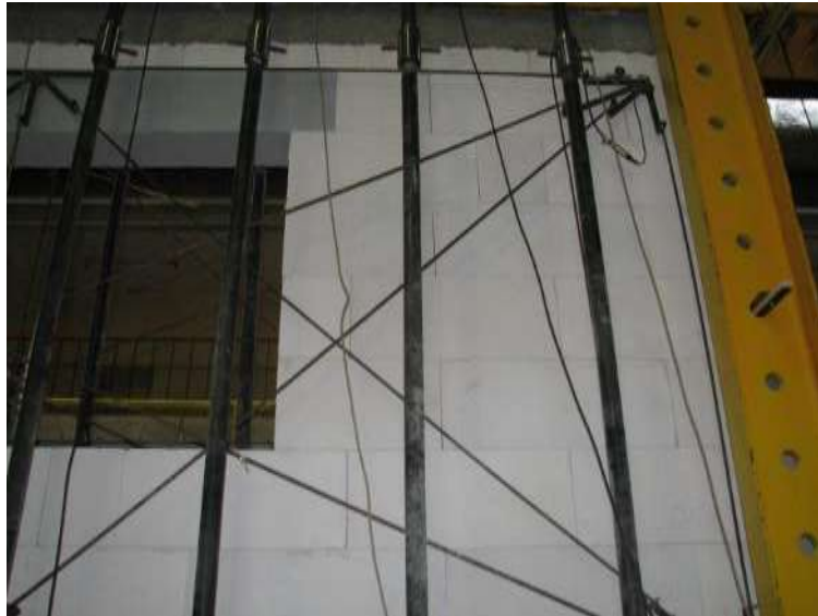
Rys. Z2.95. Pierwsze zarysowania ściany w miejscu oparcia nadproża
