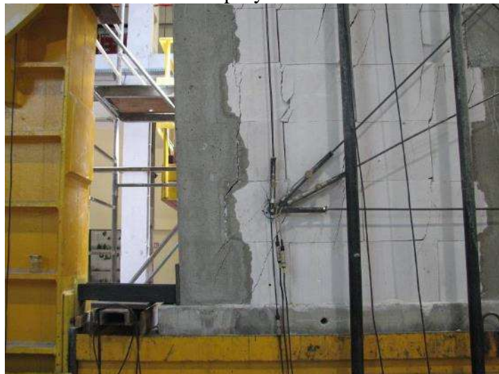
Rys. Z2.250. Zarysowania dolnej strefy rdzenia od strony podpory B
