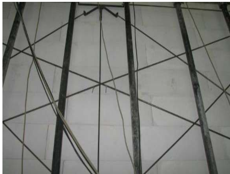
Rys.Z2. 15. Pierwsze zarysowania ściany
