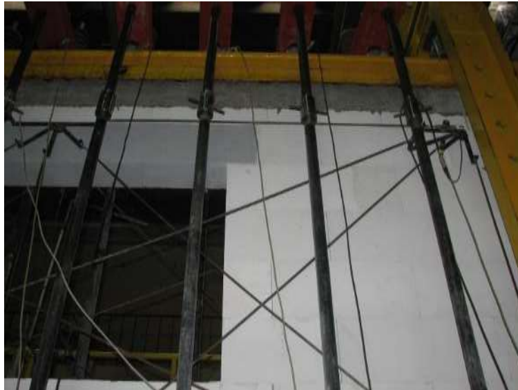
Rys. Z2.80. Pierwsze zarysowania ściany w miejscu oparcia nadproża
