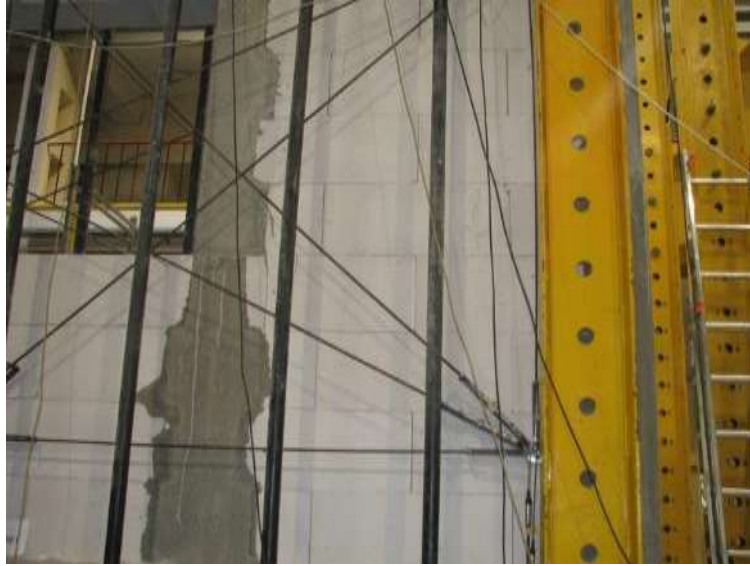
Rys. Z2.171. Zarysowania wtórne w filarku od strony podpory A
