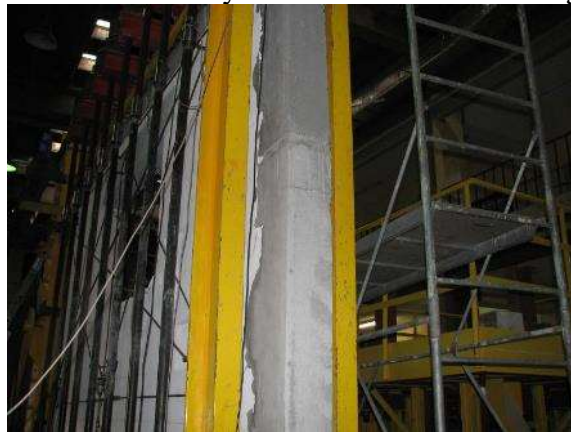
Rys. Z2.161. Poziome zarysowanie żelbetowego rdzenia w połowie wysokości od strony podpory A
