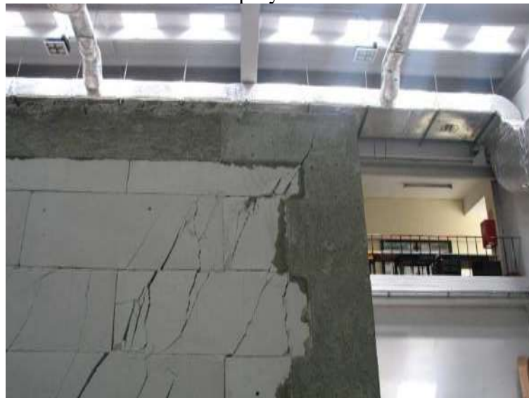
Rys. Z2.216. Ukośne rysy w górnym narożu łączącym poziomy rygiel i rdzeń od strony podpory B
