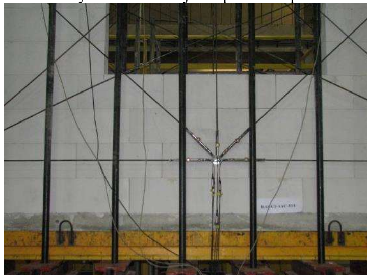
Rys. Z2.141. Pionowe, wtórne zarysowania pasa podokiennego
