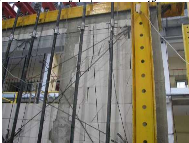
Rys. Z2.197. Ścięcie rdzenia w dolnym narożu otworu od strony podpory B
