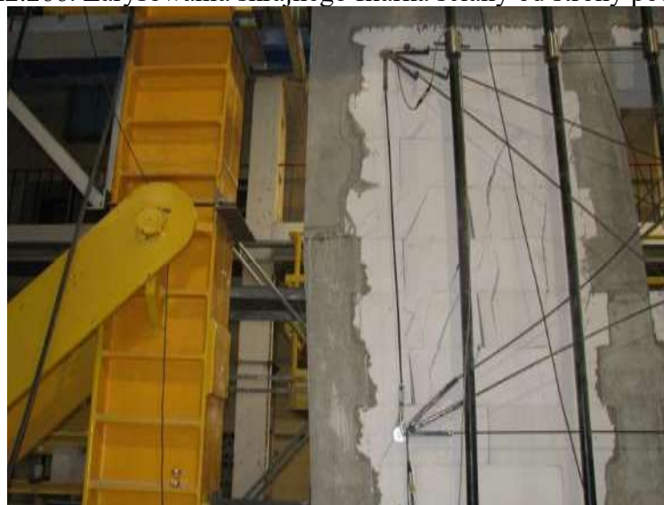
Rys. Z2.267. Poziome zarysowanie żelbetowego rdzenia w połowie wysokości od strony podpory B
