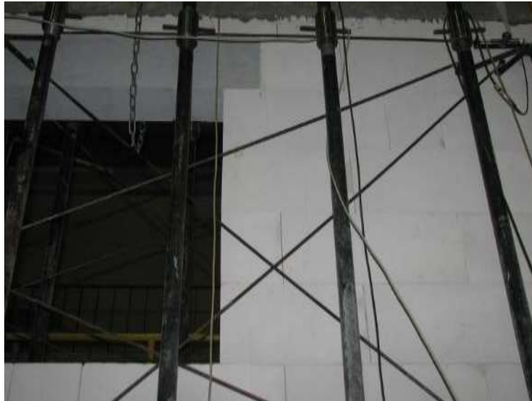
Rys. Z2.125. Pierwsze zarysowania ściany w miejscu oparcia nadproża
