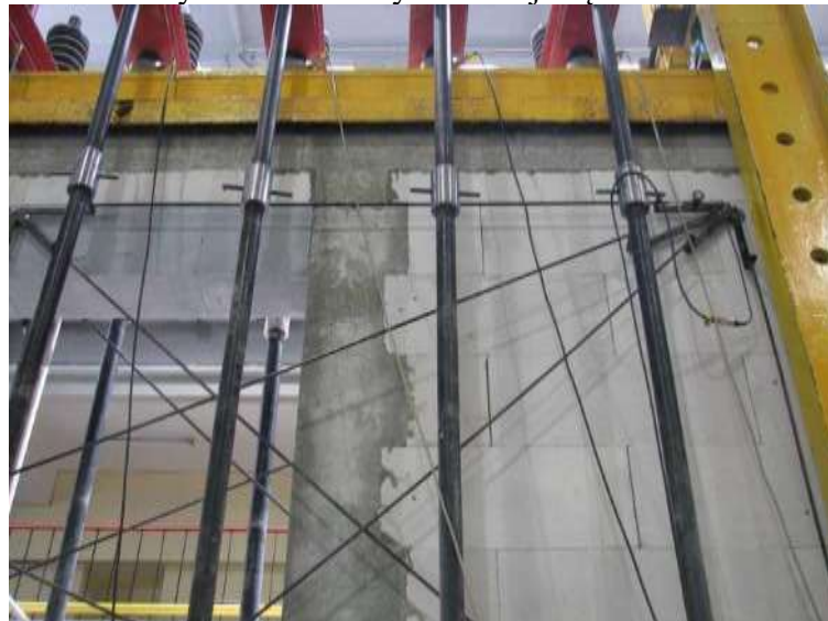
Rys. Z2.243. Pierwsze zarysowania w połowie wysokości filarka od strony podpory A
