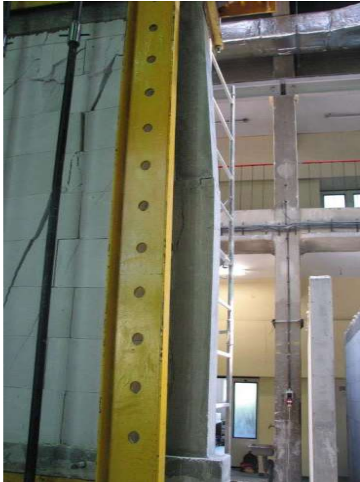
Rys. Z2.72. Zarysowania żelbetowego rdzenia w połowie wysokości od strony podpory A
