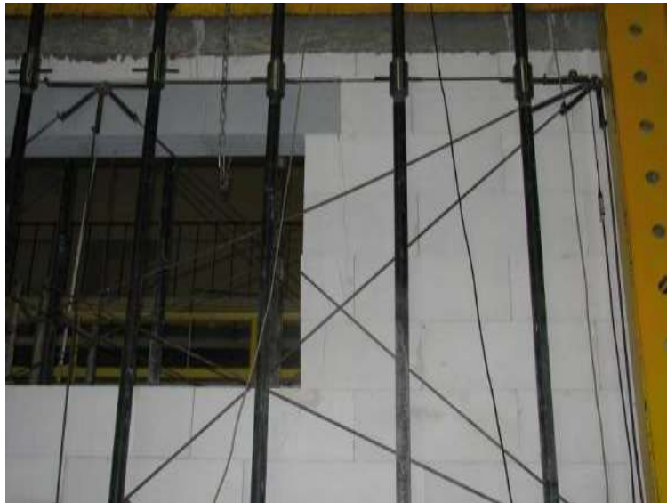
Rys. Z2.142. Zarysowania krawędzi muru od strony podpory A
