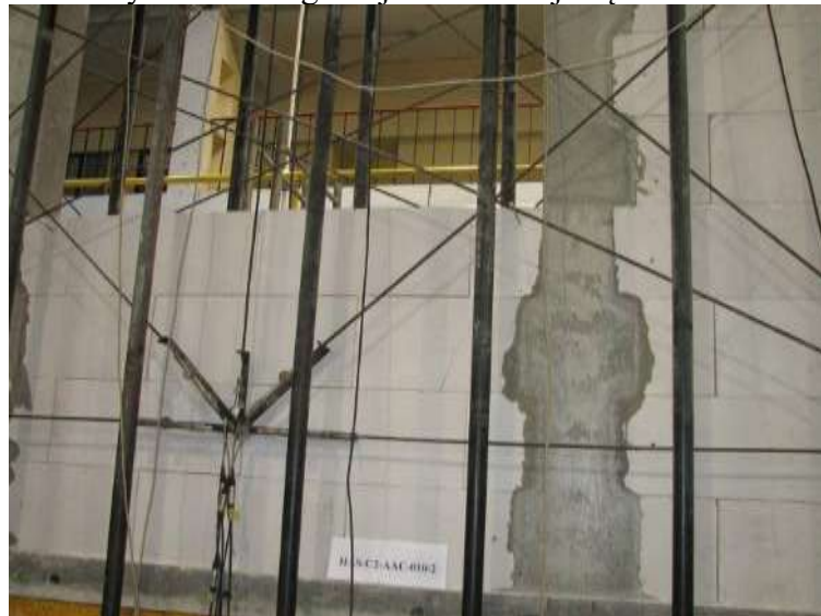
Rys. Z2.192. Zarysowania część pasa podokiennego
