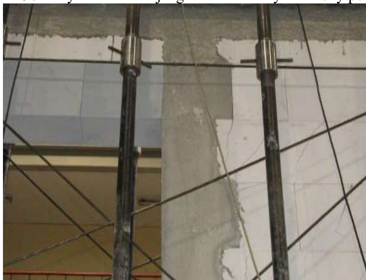
Rys. Z2.231. Zarysowania skrajnego filarka ściany od strony podpory A
