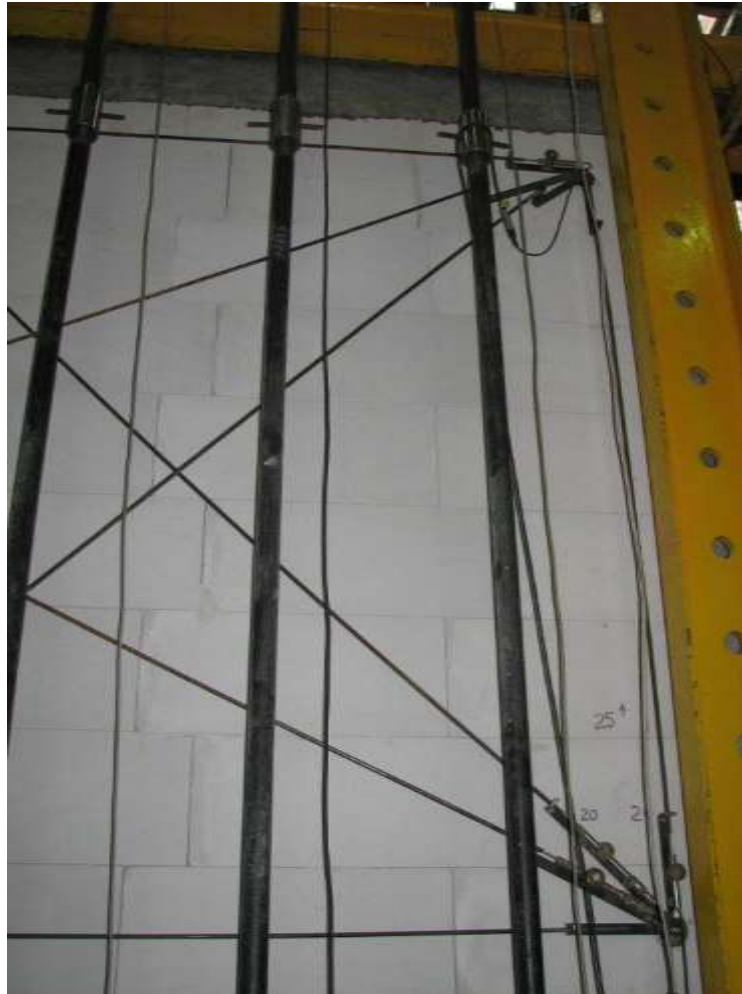
Rys. Z2. 55. Wtórne zarysowania ściany od strony podpory A
