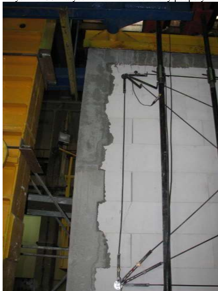
Rys. Z2.159. Pionowe zarysowania wzdłuż rdzenia od strony podpory B
