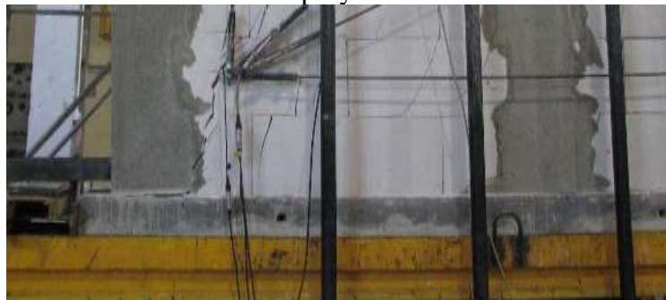
Rys. Z2.196. Zarysowania dolnego połączenia rdzenia i rygla od strony podpory B
