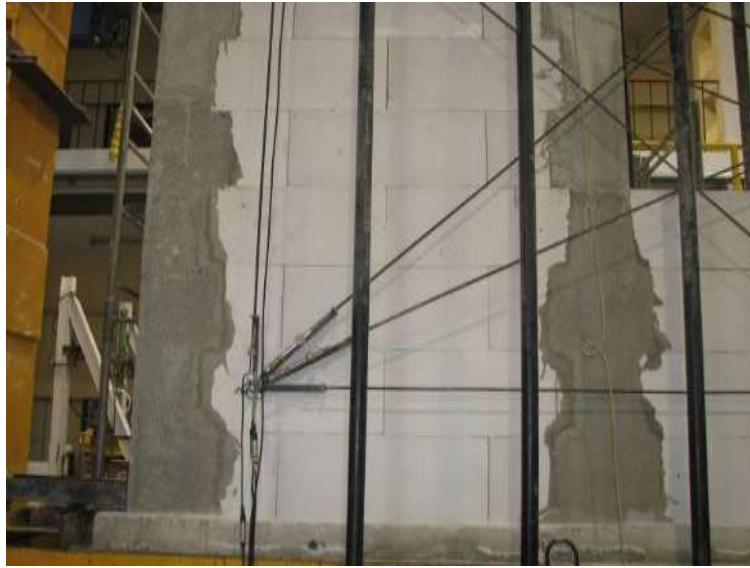
Rys. Z2.169. Pierwsze zarysowania ściany w dolnej części filarka od strony podpory B
