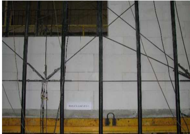
Rys. Z2.110. Pierwsze zarysowania ściany w narożu otworu okiennego
