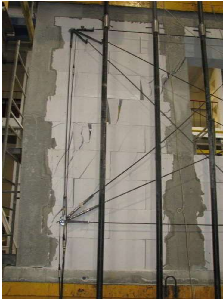
Rys. Z2.173. Zarysowania skrajnego filarka ściany od strony podpory B
