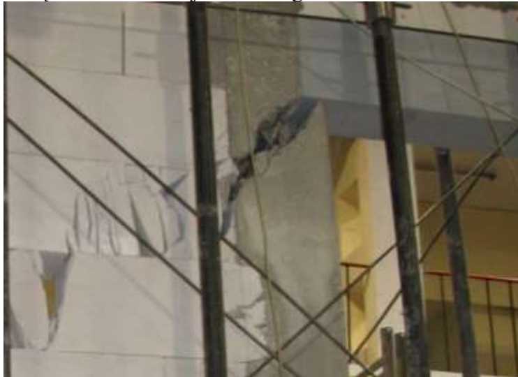
Rys. Z2.178. Ścięcie rdzenia w rejonie górnego naroża otworu od strony podpory A
