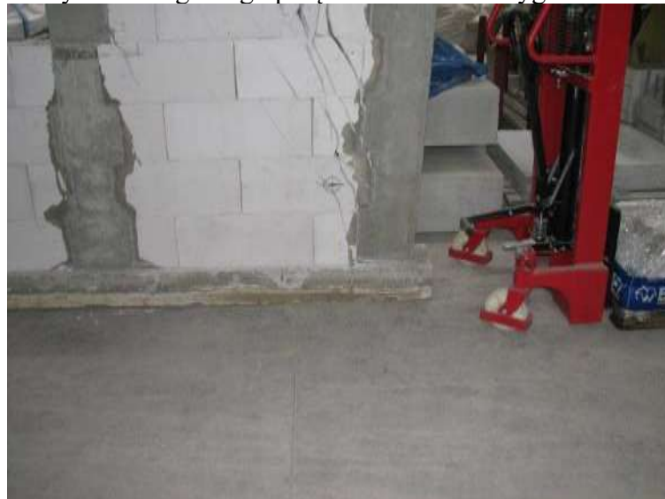
Rys. Z2.180. Zarysowania dolnego połączenia rdzenia i rygla od strony podpory B
