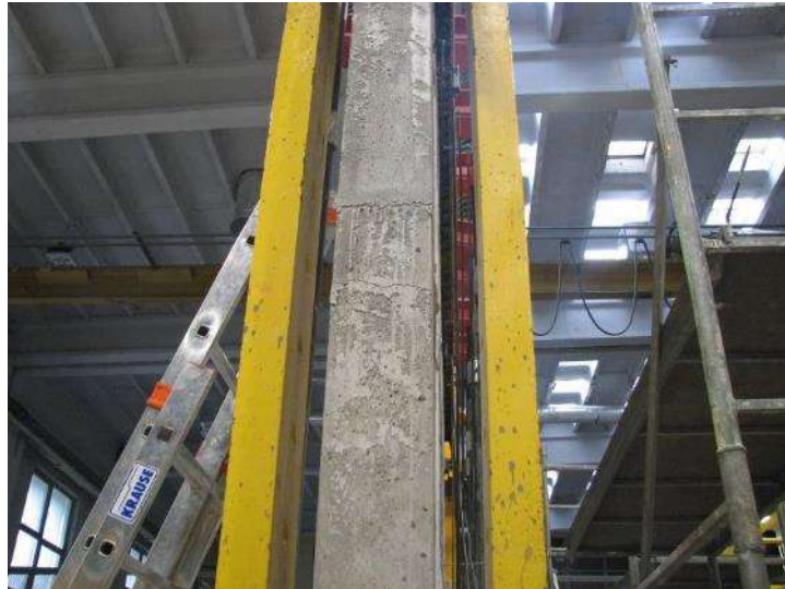
Rys. Z2.268. Poziome zarysowanie żelbetowego rdzenia w połowie wysokości od strony podpory A
