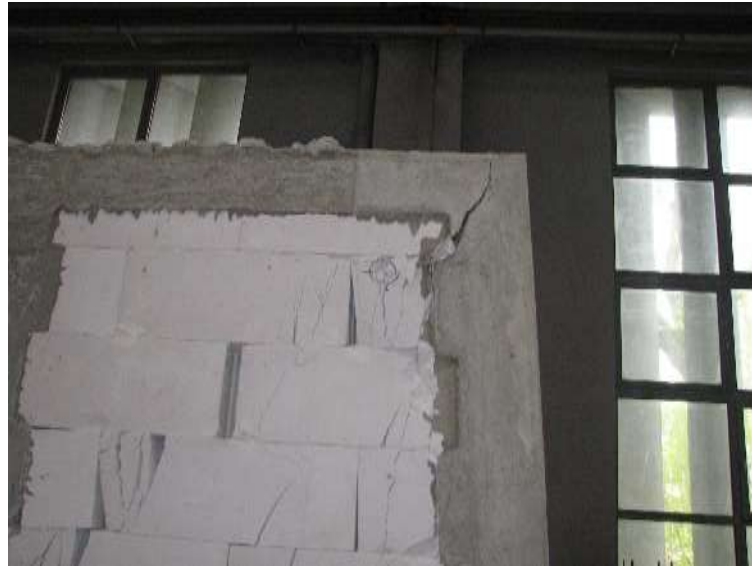
Rys. Z2.179. Zarysowania górnego połączenia rdzenia i rygla od strony podpory A
