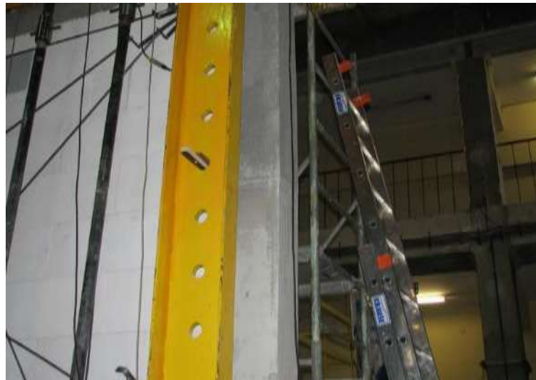
Rys. Z2.102. Poziome zarysowania żelbetowego rdzenia w połowie wysokości od strony pod-
