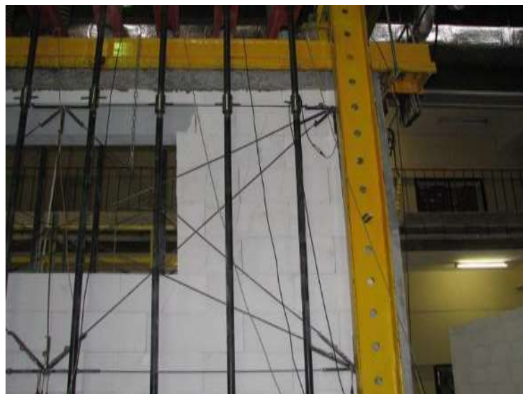
Rys. Z2.114. Zarysowania filarka od strony podpory A
