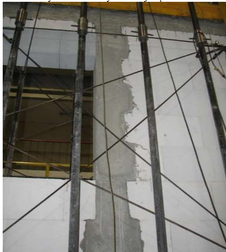
Rys. Z2.260. Pierwsze zarysowania w narożu otworu okiennego od strony podpory A
