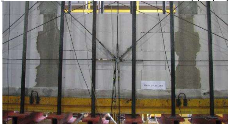
Rys. Z2.246. Zarysowania część pasa podokiennego
