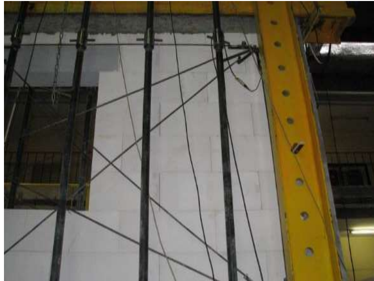
Rys. Z2.113. Wtórne zarysowania ściany w filarku nad podporą B
