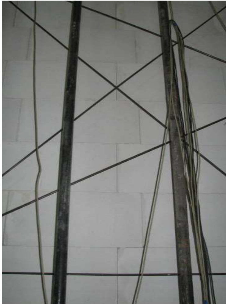
Rys.Z2. 54. Pierwsze zarysowania ściany
