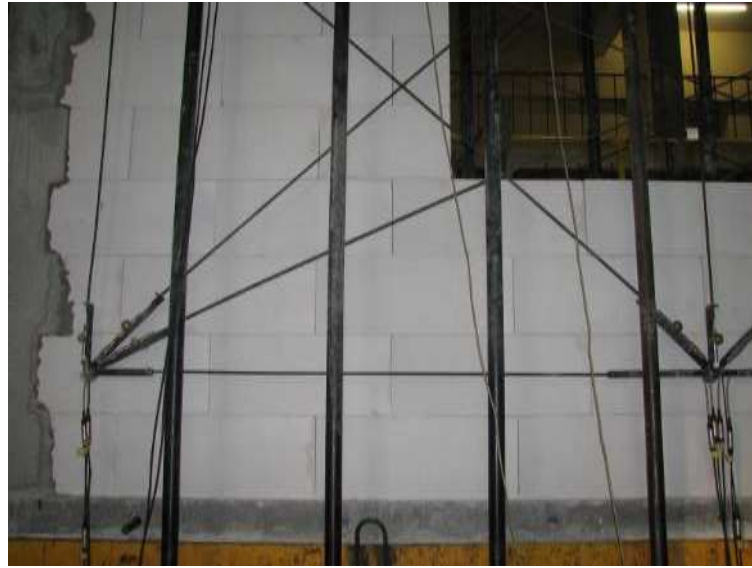
Rys. Z2.156. Wtórne, ukośne zarysowania filarka od strony podpory B
