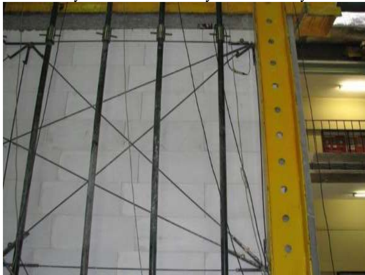
Rys.Z2. 17. Wtórne zarysowania ściany
