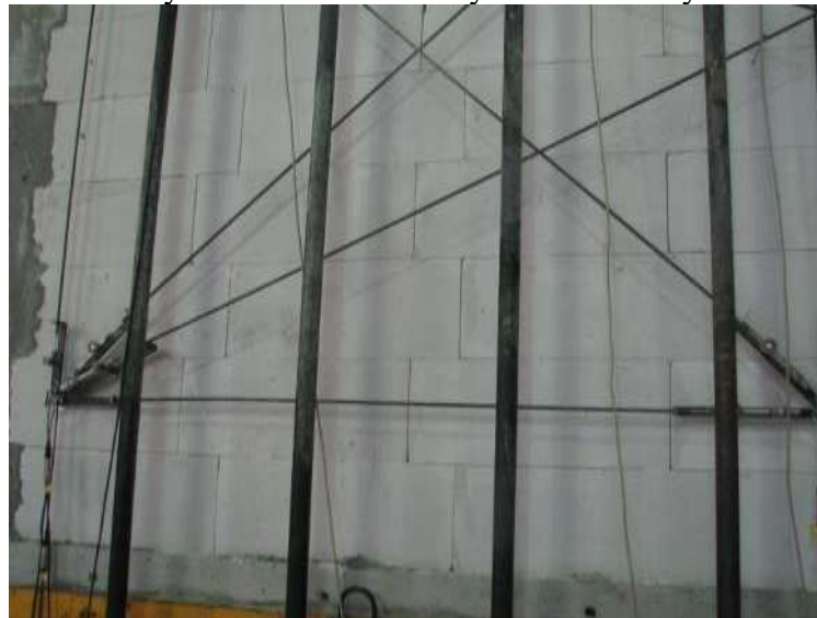
Rys.Z2. 30. Wtórne zarysowania ściany
