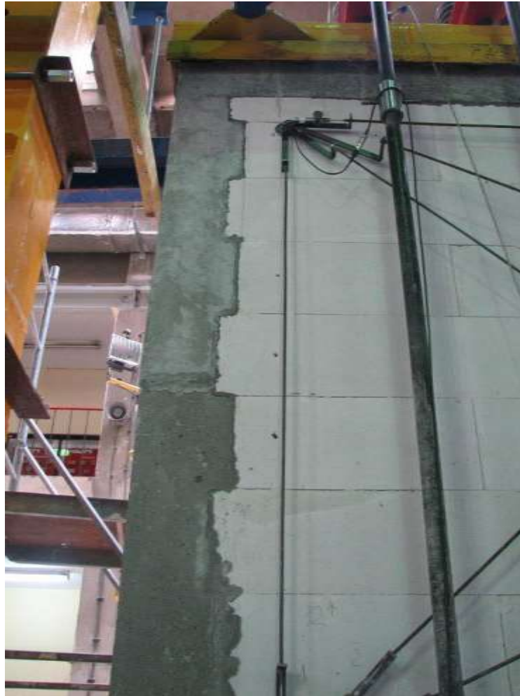
Rys.Z2. 28. Zarysowania muru w styku z żelbetowym rdzeniem
