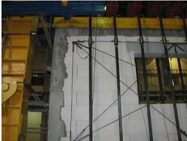
Rys. Z2.158. Zarysowania filarka od strony podpory B
