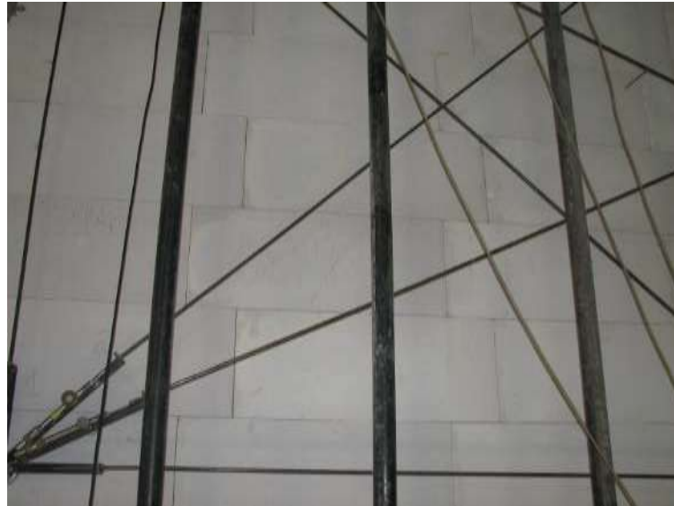
Rys.Z2. 5. Pierwsze zarysowania ściany
