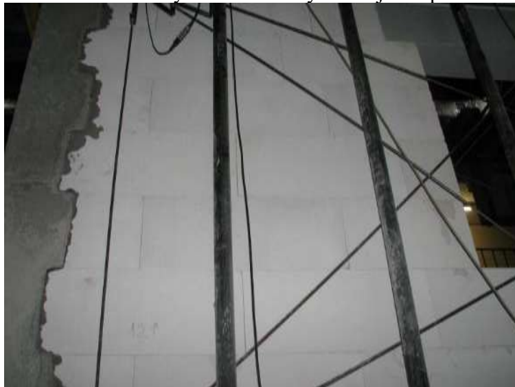
Rys. Z2.81. Wtórne zarysowania filarka od strony podpory B
