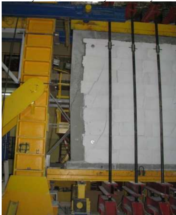
Rys. Z2. 58. Zarysowania żelbetowego rdzenia nad podporą B
