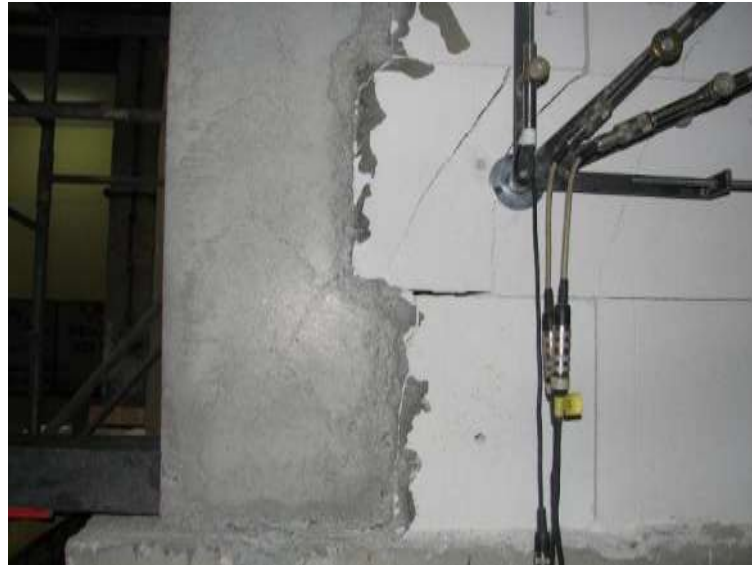
Rys. Z2.86. Zarysowania żelbetowego rdzenia nad podporą B
