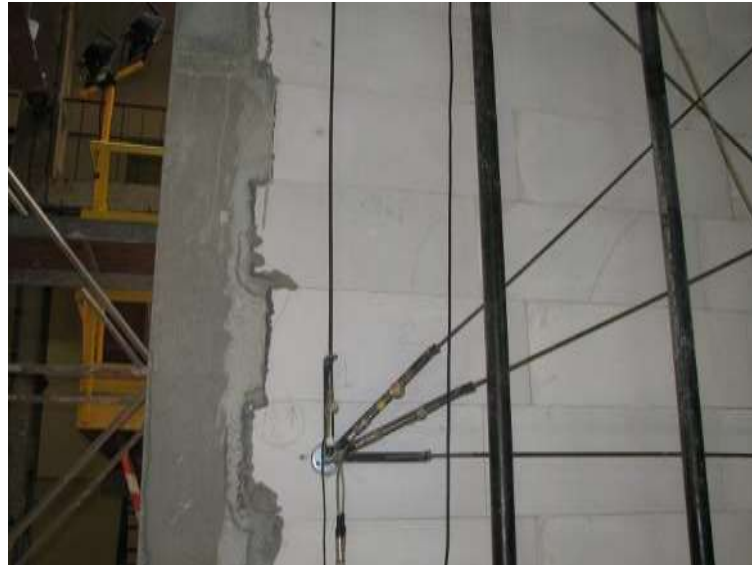
Rys.Z2. 7. Wtórne zarysowania ściany
