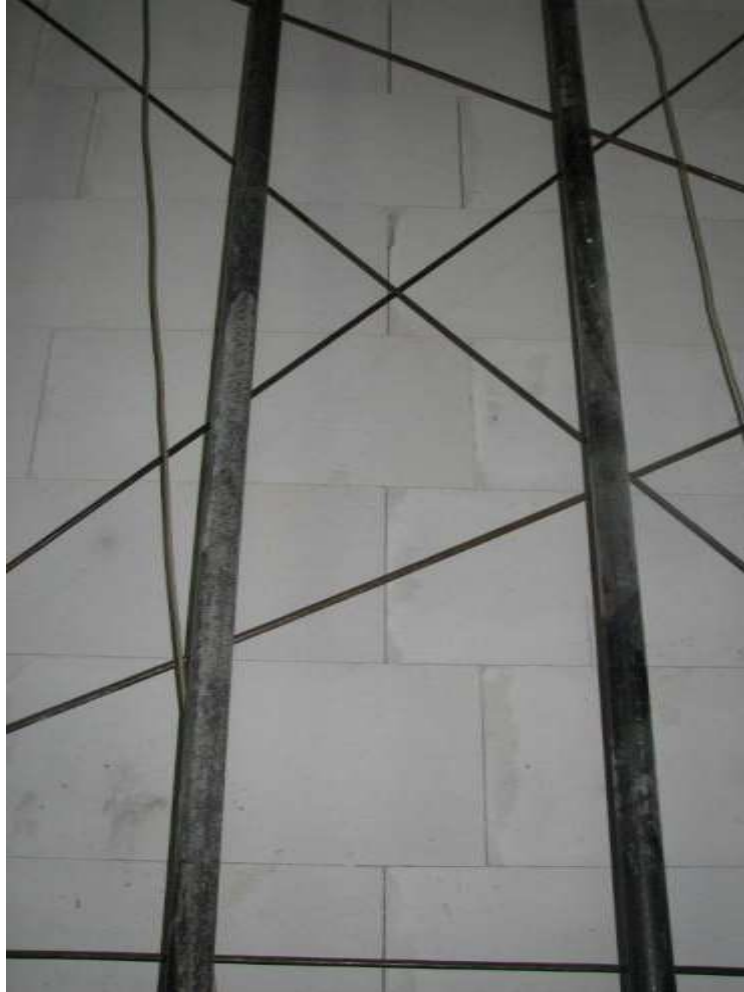
Rys.Z2. 27. Pierwsze zarysowania ściany
