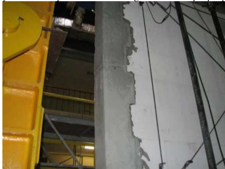
Rys. Z2.87. Poziome zarysowania żelbetowego rdzenia w połowie wysokości od strony podpory A
