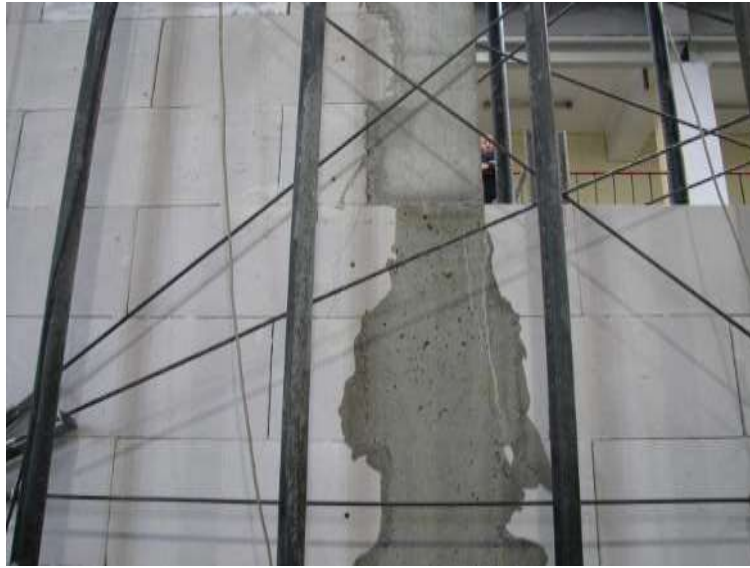
Rys. Z2.188. Pierwsze zarysowania ściany w dolnej części filarka od strony podpory B
