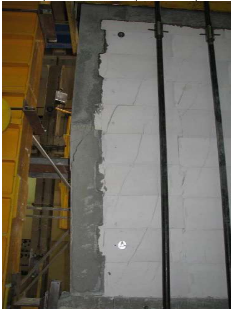
Rys. Z2.71. Zarysowania żelbetowego rdzenia nad podporą B
