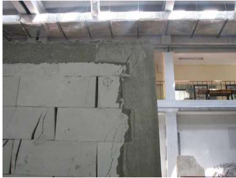
Rys. Z2.198. Ukośne rysy w górnym narożu łączącym poziomy rygiel i rdzeń od strony podpory B
