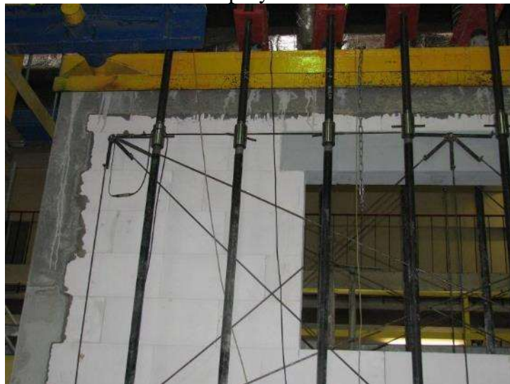
Rys. Z2.140. Pionowe zarysowania w miejscu oparcia nadproża od strony podpory B
