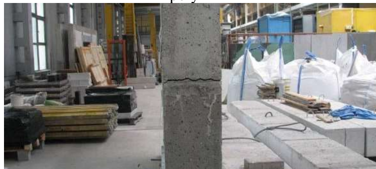
Rys. Z2.217. Pozioma rysa w ryglu od strony podpory A
