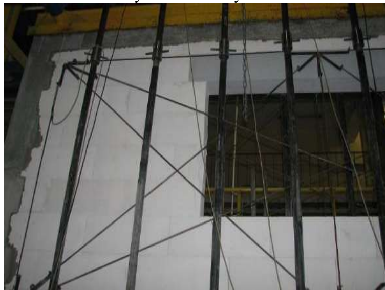
Rys. Z2.111. Pierwsze zarysowania w filarku od strony podpory B
