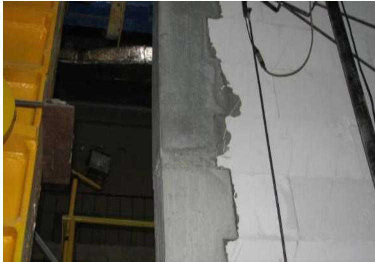
Rys. Z2.117. Poziome zarysowania żelbetowego rdzenia w połowie wysokości od strony pod-
