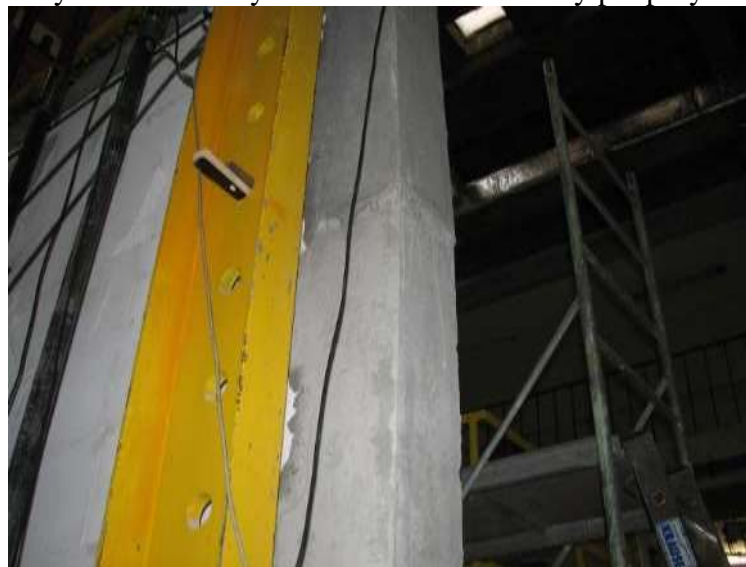
Rys. Z2.116. Poziome zarysowania żelbetowego rdzenia w połowie wysokości od strony podpory A
