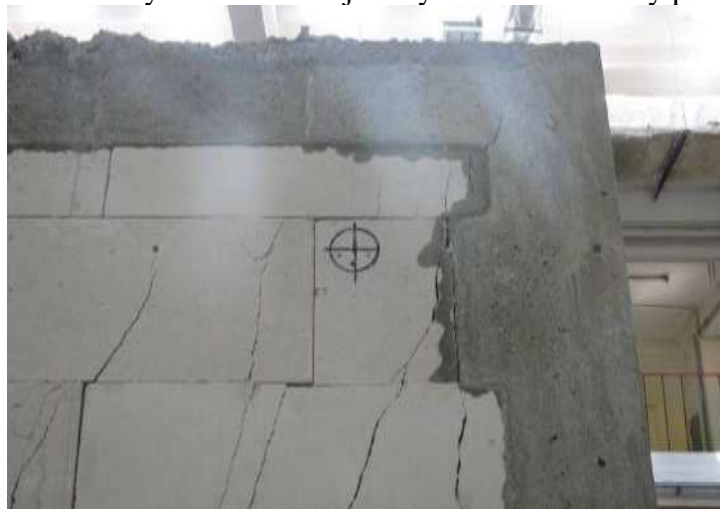
Rys. Z2.251. Ukośne rysy w górnym narożu łączącym poziomy rygiel i rdzeń od strony podpory B
