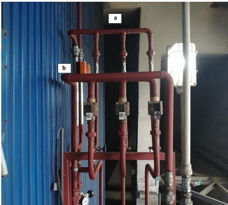
Rys. 5.10 Kolektory sprężonego powietrza a - chłodzącego oraz b – mieszającego z elektrozaworami zlokalizowane na ścianie lewej kotła
