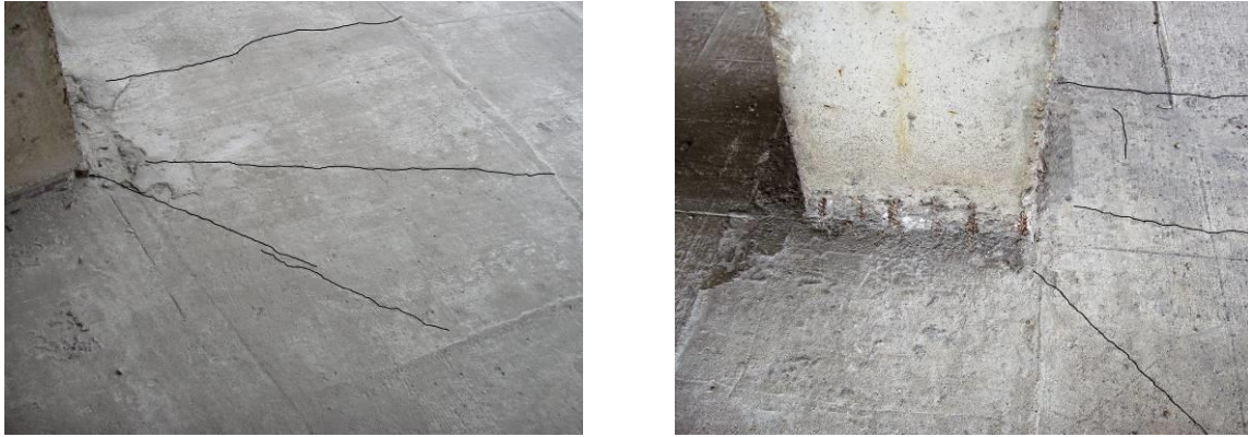
Rys. 12. Zarysowania przy słupach na górnej powierzchni stropu Fig. 12. Crack patterns close to the columns on the upper surface of the floor slab
