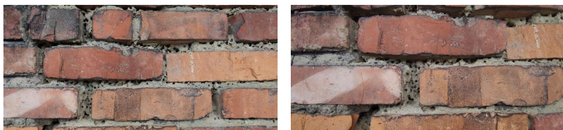
Rys. 7. Mechaniczna erozja spoiny
