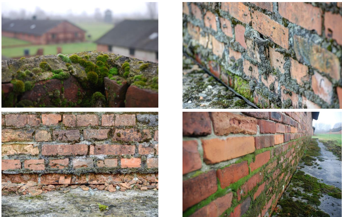
Rys. 6. Uszkodzenia cegieł, rozmrożenia, mchy i porosty Fig. 6. Damage to bricks, thawing, mosses and lichens
