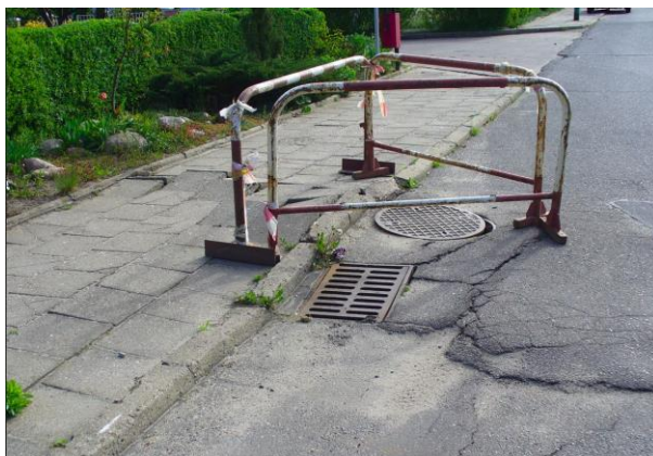
Rys. 5. Zniszczenie kielicha kamionkowej rury kanalizacyjnej Fig. 5. Destruction of the socket of a stoneware sewer pipe
