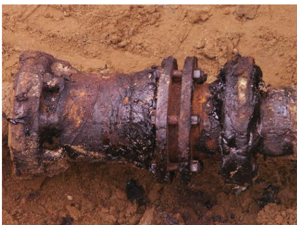
Rys. 8. Wgniecenie końcówek rur stalowych do zbiornika zamknięcia hydraulicznego gazociągu Fig. 8. Dent of the ends of the steel pipes into the tank of the hydraulic closure of the gas pipeline
