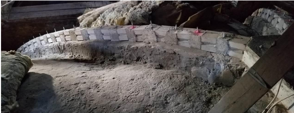
Rys. 7. Wzmocnienie żeber sklepień w kościele pw. Św. Wawrzyńca w Rudzie Śląskiej przez zastosowanie półprefabrykowanego żebra żelbetowego
