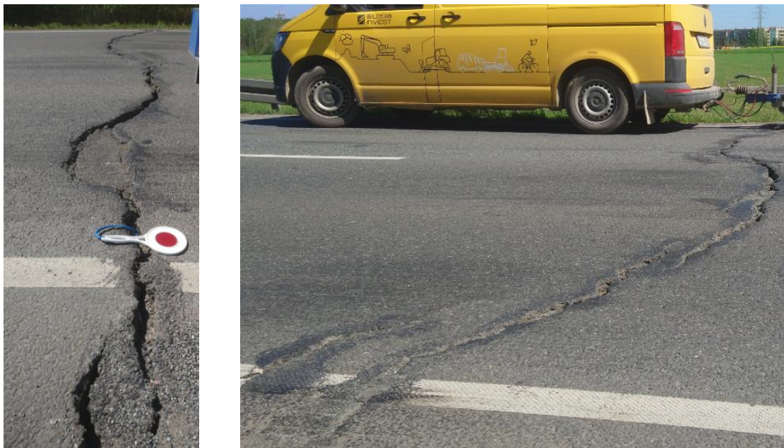
Rys. 22. Przykład uszkodzeń nawierzchni ujawnionych w rejonie LNDP Fig. 22. An example of pavement damage revealed in the area of LDS
