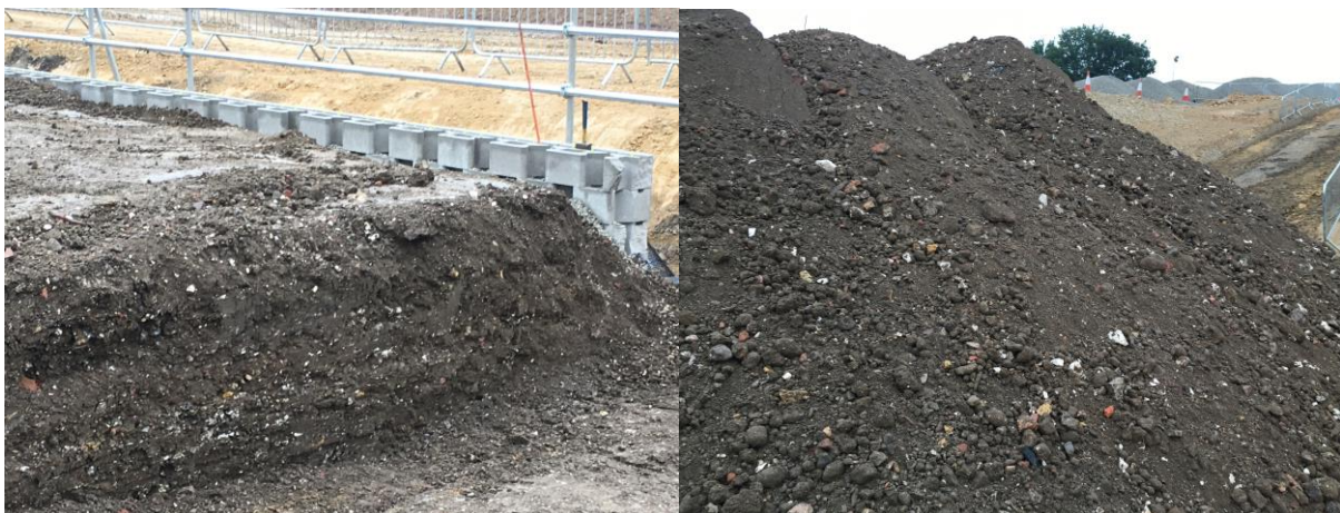
Rys. 14. Materiał zasypowy deponowany w sposób niekontrolowany Fig. 14. Uncontrolled fill material
