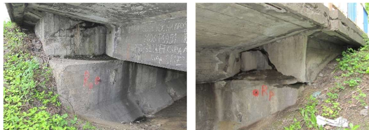
Rys. 2. Przyczółek od Pawłowic – pęknięcia ścianki zapleczyńnej (rok 2013)
