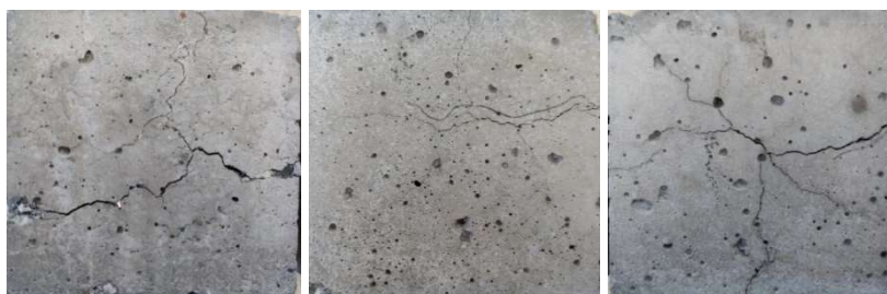
Rys. 2. Pęknięcia ścian próbki zarobów od lewej: Z4-69, Z5-50, Z7-63
