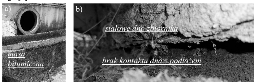
Rys. 1. Posadowienie zbiorników stalowych a) wyciśnięta masa bitumiczna, b) wymyte podłoże
