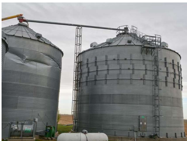
Rys. 1. Uszkodzenie ściany stalowego silosu pod wpływem huraganowego wiatru
