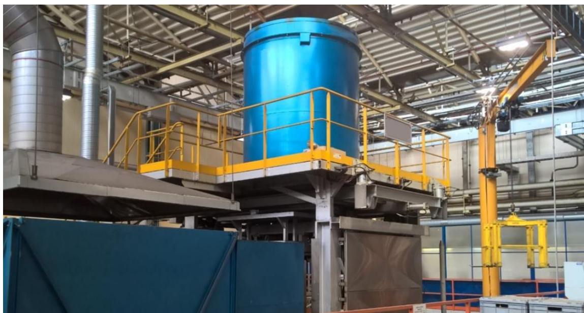
Rys. 52. instalacji przemysłowej zlokalizowanej w Avio Polska.
