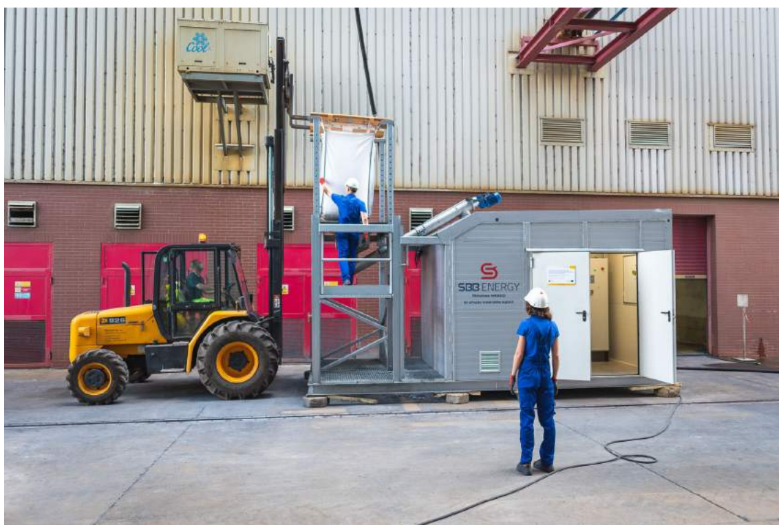
Rys. 4.7. Praca pilotażowej instalacji dozowania sorbentów sypkich
