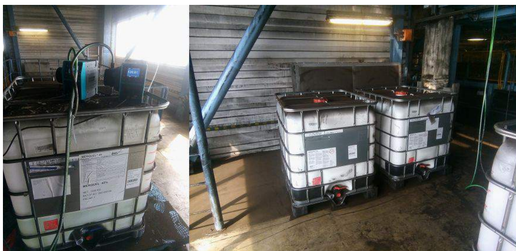
Rys. 4.23. Instalacja dozowania soli bromu.
