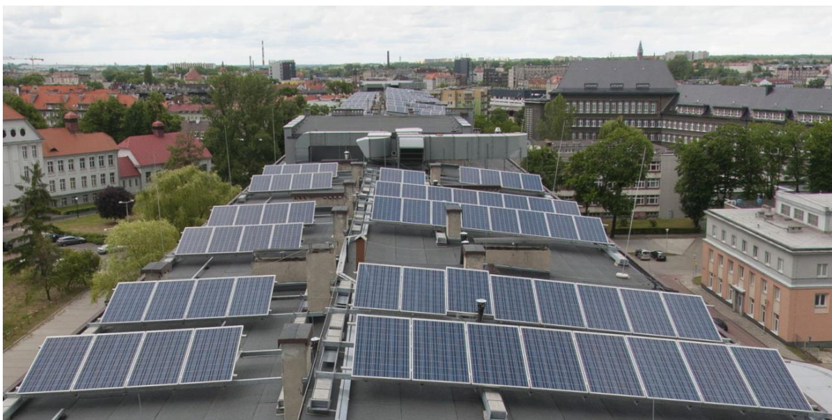
Rys. 4.1. Elektrownia fotowoltaiczna znajdująca się na dachu Wydziałów IŚiE i MT Politechniki Śląskiej [153]
