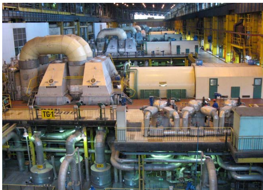
Rys. 5.58. Widok hali maszyn energetycznych z turbozespołem TG-1 poddany cyklicznej obserwacji termograficznej
