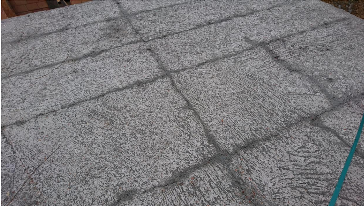
Rys. 54. Zarysowania na stropie wywołane nieodpowiednią pielęgnacją betonu Fig. 54. Cracks on the ceiling caused by improper concrete care
