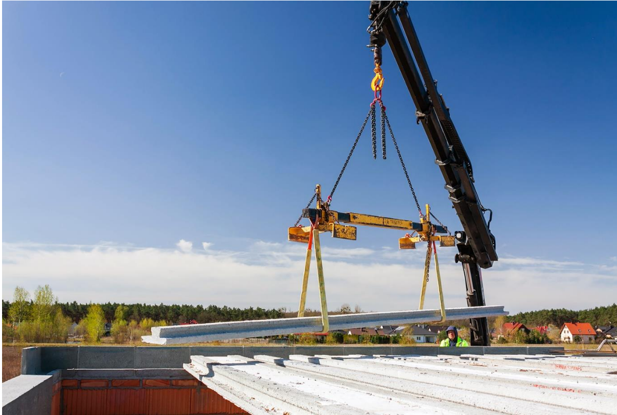
Rys. 31. Montaż płyty uzupełniającej Teriva Panel za pomocą dźwigu HDS Fig. 31. Installation of Teriva Panel supplementary panel using a HDS crane
