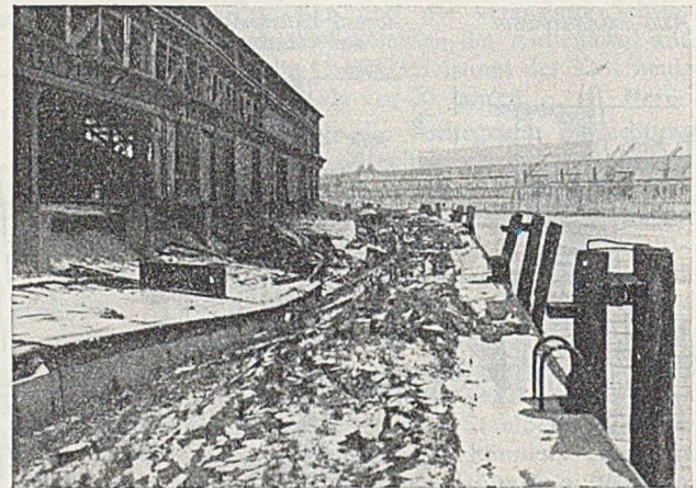
Abb. 5. Kaimauer vor dem Einsturz am Schuppen 51 (Hansehafen).
