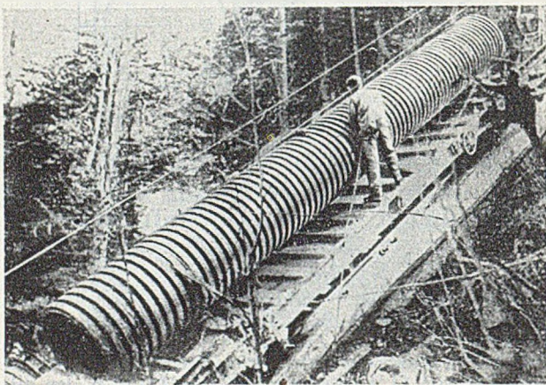
Abb. 2. Druckrohrleitung Portillon mit starren Bandagen.
