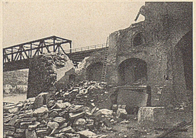
Abb. 16. Teilabbruch der Kasematten am linken Landwiderlager. Die Widerlager mußten umgebaut werden zur Aufnahme der lotrechten Auflagerkräfte an Stelle der bisherigen, schrägen Auflagerkräfte aus den Zweigelenkbogen.
