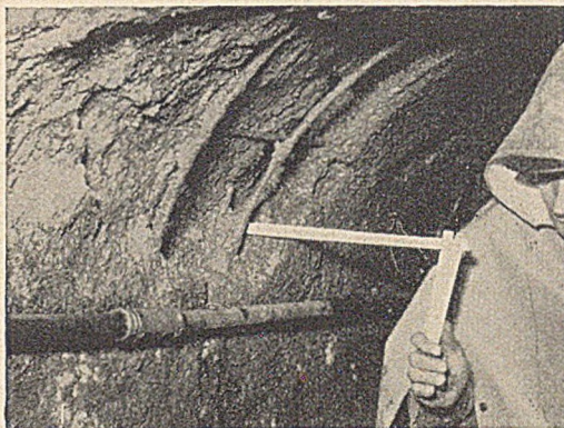
Abb. 2. Sulfaterstörungen im Piesbergdüker am Zweigkanal nach Osnabrück.
