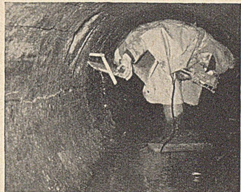
Abb. 4. Abkratzen des durch sulfathaltige Wasser zermürbten Betons.
