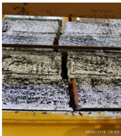
Fot. 8.4.1-7. Zbliżenie pęknięcia cegieł i spoin w dolnej części elementu badawczego C.2 Photo 8.4.1-7. Close-up of cracked bricks and joints at the bottom of test element C.2
