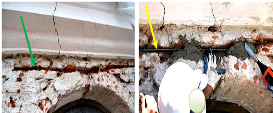
Fot. 3.4-2. Naprawa pęknięcia ściany z łukowym nadprożem w Świętej Lipce [W 6 i 7]
