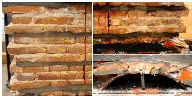
Fot. 5.2.3-7. Widok zniszczeń nad lewą podporą muru (ściana przednia i tylna) Photo 5.2.3-7. View of the damage above the left wall support (front and rear walls)
