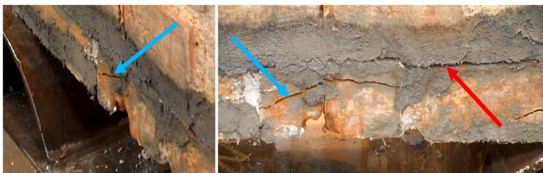
Fot. 5.2.3-5. Zarysowania w murze pod dolnym wzmocnieniem (tylna ściana) Photo. 5.2.3-5. Scratches in the wall under the lower reinforcement (back wall)
