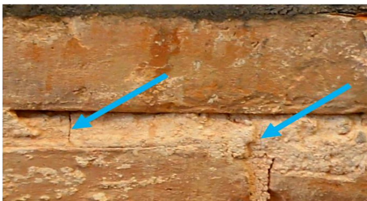
Fot. 5.2.3-4. Pionowe zarysowania spoiny wspornej na przedniej ścianie elementu badawczego Photo. 5.2.3-4. Vertical scratches in the support weld on the front wall of the test element
