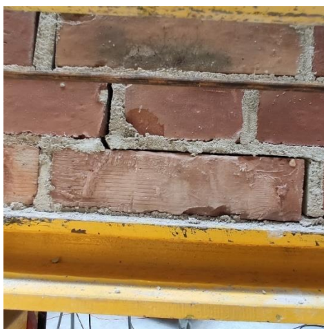
Fot. 8.4.1-8. Zbliżenia obustronnych pęknięć w narożach pod otworem okna Photo. 8.4.1-8. Close-ups of the cracks on both sides in the corners under the window opening
