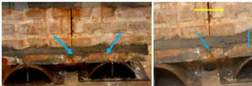
Fot. 5.2.3-6. Widok zarysowań pod dolnym wzmocnieniem oraz w spoinie pionowej (tylna ściana) Photo. 5.2.3-6. View of scratches under the lower reinforcement and in the vertical joint (rear wall)
