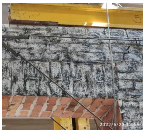
Fot. 8.4.1-6. Widok pęknięcia w narożu z prawej strony nad otworem okna Photo 8.4.1-6. View of the crack in the corner on the right above the window opening
