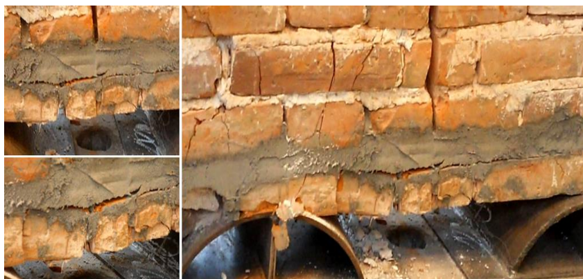
Fot. 5.2.3-8. Widok zniszczeń muru pod dolnym wzmocnieniem (przednia ściana). Photos. 5.2.3-8. View of the damage to the wall under the lower reinforcement (front wall).
