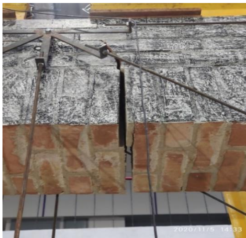
Fot. 8.4.1-2. Widok pęknięcia w środkowej części łukowego nadproża Photo 8.4.1-2. View of a crack in the central part of the arched lintel
