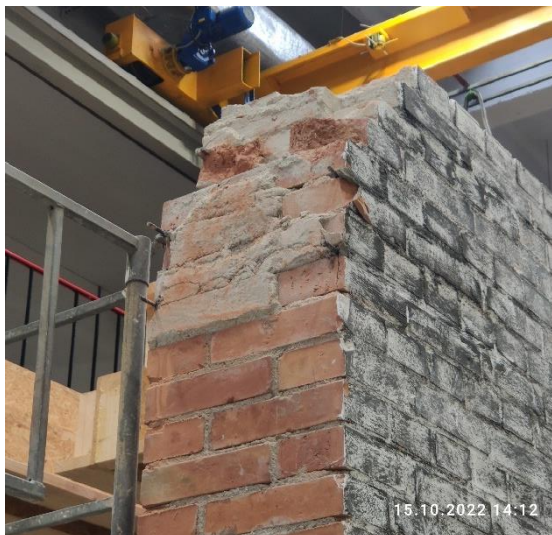
Fot. 8.4.3-6. Widok fragmentu elementu badawczego C.2-1 po zniszczeniu Photo. 8.4.3-6. View of a fragment of research element C.2-1 after destruction
