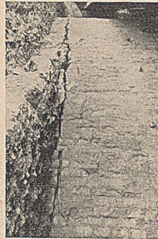
Bild 10. Bauwerk in den Rampen der Rendsburger Hochbrücke. Riß im Gewölbe am Ansaß der Stirnmauer von oben gesehen.
