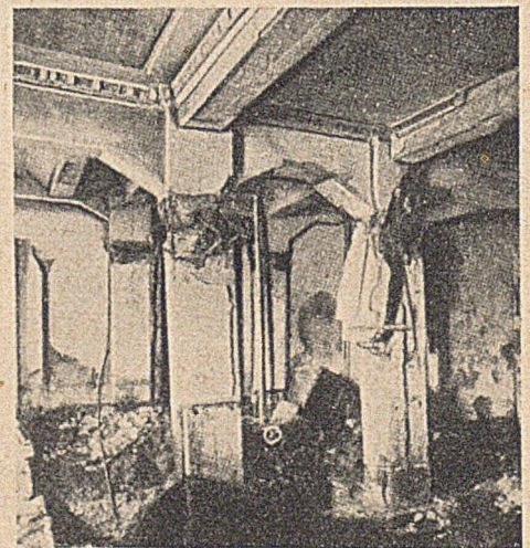
Abb. 4. Stahlbetonbau in Yokohama: Zermalmten der unzureichend bewehrten Säulenköpfe beim Erdbeben 1923.
