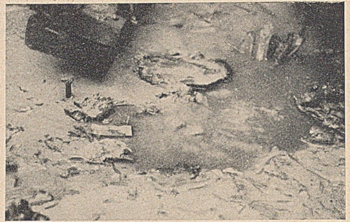
Bild 11. Quellen im Baugrund nach dem Abspumpen.
