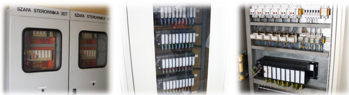
Rys. 90. Przykłady PLC zamontowanych w szafach sterowniczych 44 Fig. 90. Example of PLC mounted in cabinets
