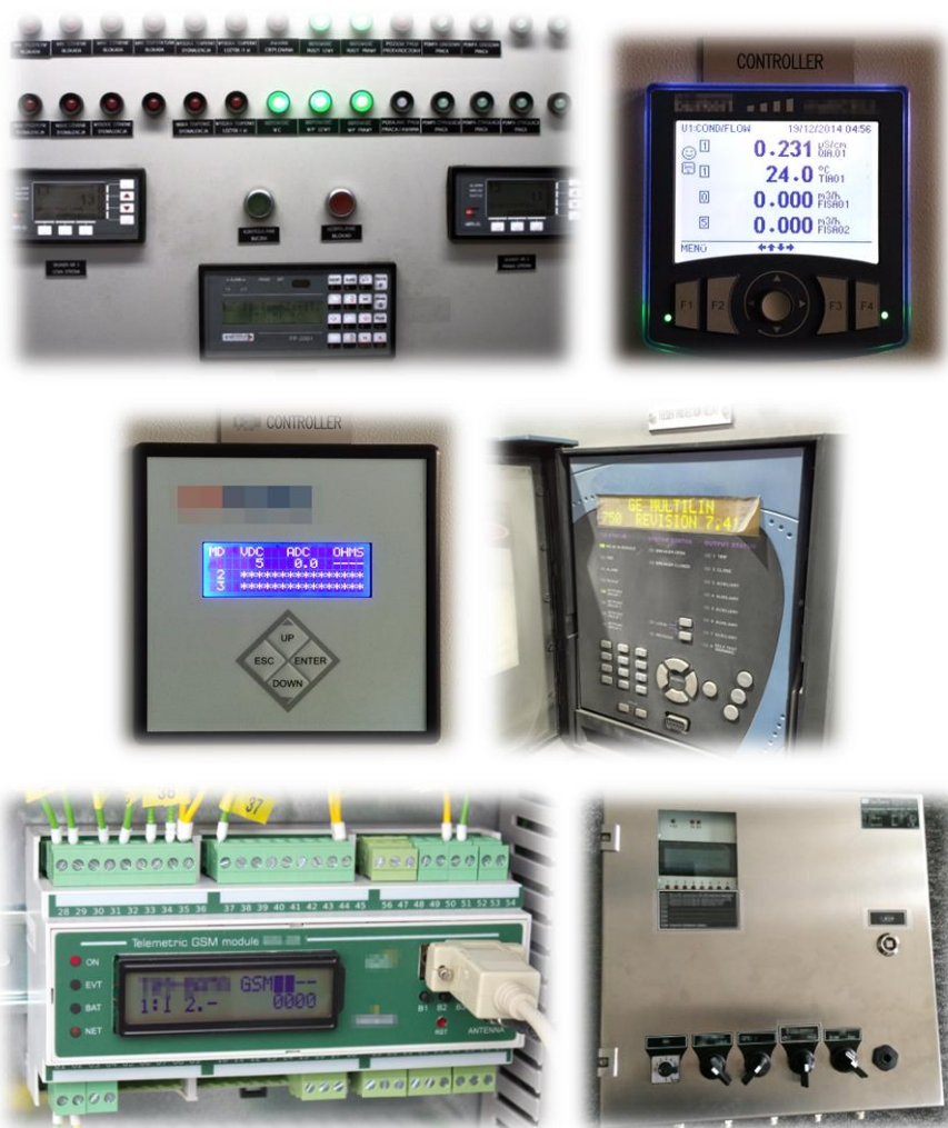
Rys. 98. Przykład zastosowania prostej synoptyki i sterowników dedykowanych 54 Fig. 98. Examples of simple synoptic and dedicated controllers usage
