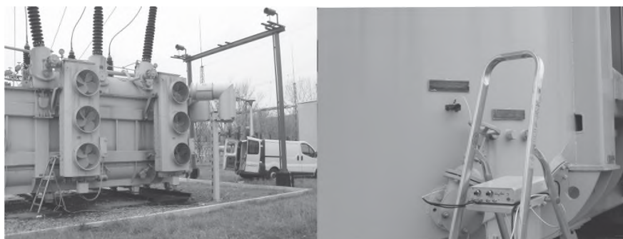
Rys. 6.5. Pomiary WNZ przy zastosowaniu metody EA podczas normalnej pracy transformatora elektroenergetycznego [7]
