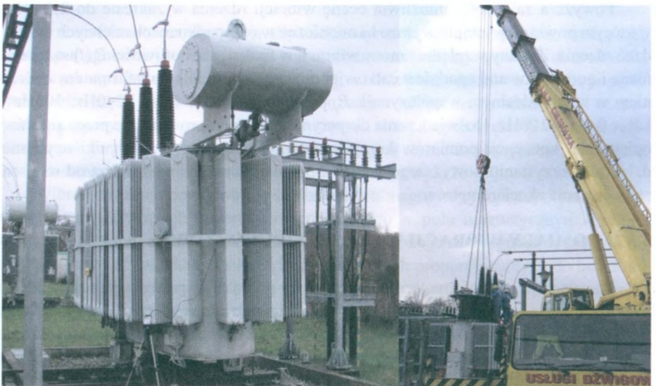
Rys. 1. Transformator 110/15 kV, 16 MVA podczas badań
