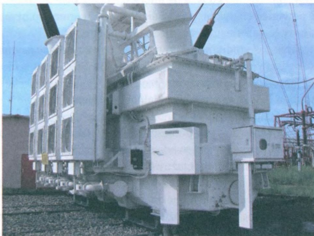
Rys. 5. Transformator Hitachi AFLOC-3MNYCP z PZZ typu LRY-01
