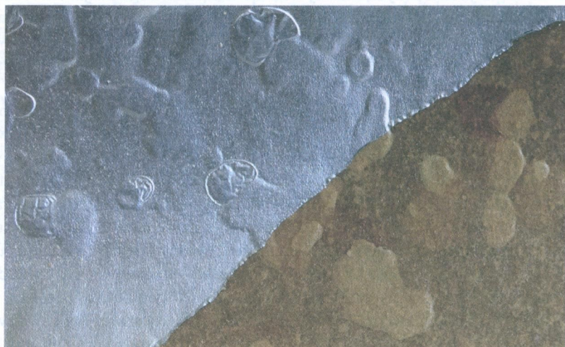
Rys. 4. Widok powierzchni warstwy rdzenia przepustu RBP CTF 245 kV po 32 latach eksploatacji
