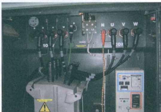
Rys.1. Wnętrze szafy transformatora
