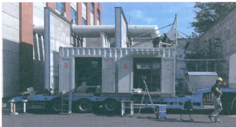
Rys. 8. Mobilny generator do prób napięciowych wraz z układem pomiaru WNZ
