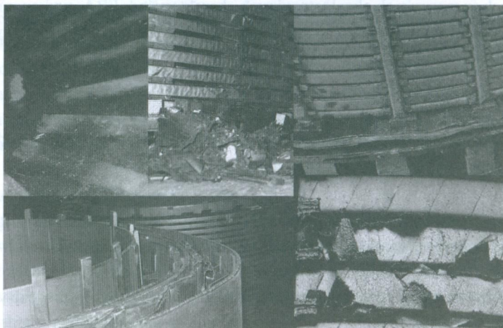
Rys. 4.29. Widok osadów na elementach stałych izolacji transformatorów
