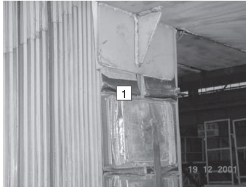
Rys. 8. Pofalowana blacha kolumnowa 1 rdzenia dwuramowego autotransformatora RTdxP125000/200 z widocznymi śladami przegrzania.
