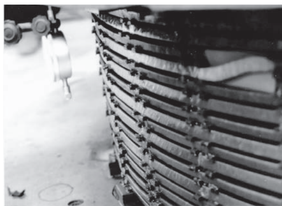
Rys. 15. Uszkodzone uzwojenie GN transformatora 270MVA/220 stwierdzone po awarii bloku i samego transformatora. Pochylone przewody wskazują na wystąpienie w czasie awarii dużych nacisków osiowych.
