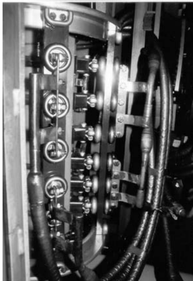
Rys. 20. Otwarty właz w ścianie kadzi transformatora piecowego z widokiem na wybierak przełącznika typu M 1 1500.
