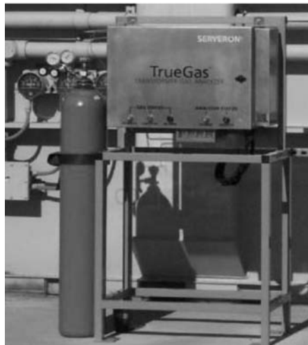
Rys. 1.8. Widok analizatora TrueGas zamontowanego przy transformatorze[9]
