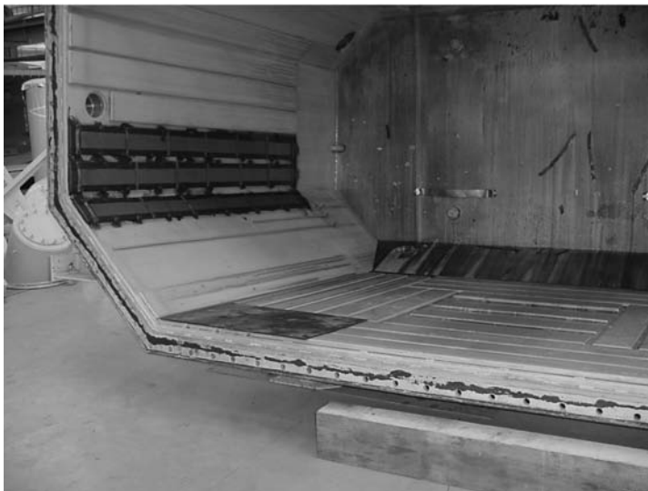
Rys. 19. Ekran magnetyczny kadzi transformatora blokowego 270MVA -220kV
