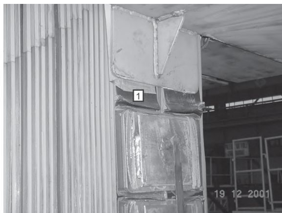
Rys. 3.8. Pofalowana blacha kolumnowa 1 rdzenia dwuramowego autotransformatora RTdxP125000/200 z widocznymi śladami przegrzania.
