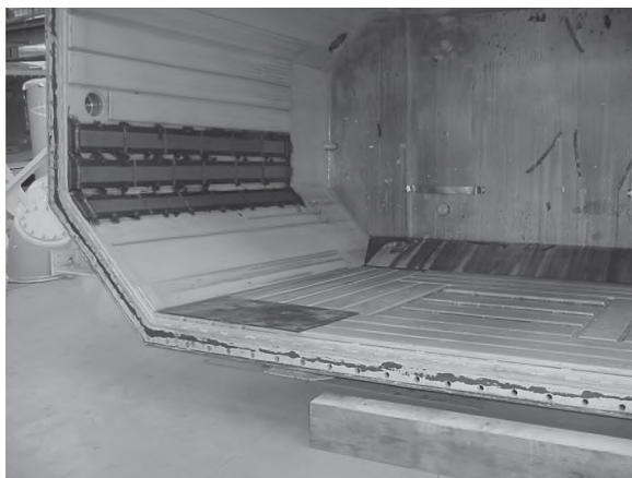
Rys. 3.19. Ekran magnetyczny kadzi transformatora blokowego 270MVA -220kV
