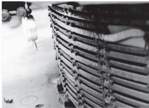
Rys. 3.15. Uszkodzone uzwojenie GN transformatora 270MVA/220 stwierdzone po awarii bloku i samego transformatora. Pochylone przewody wskazują na wystąpienie w czasie awarii dużych nacisków osiowych
