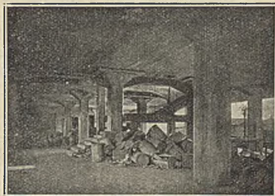
Strop grzybkowy magazynu kolejowego we Lwowie.
