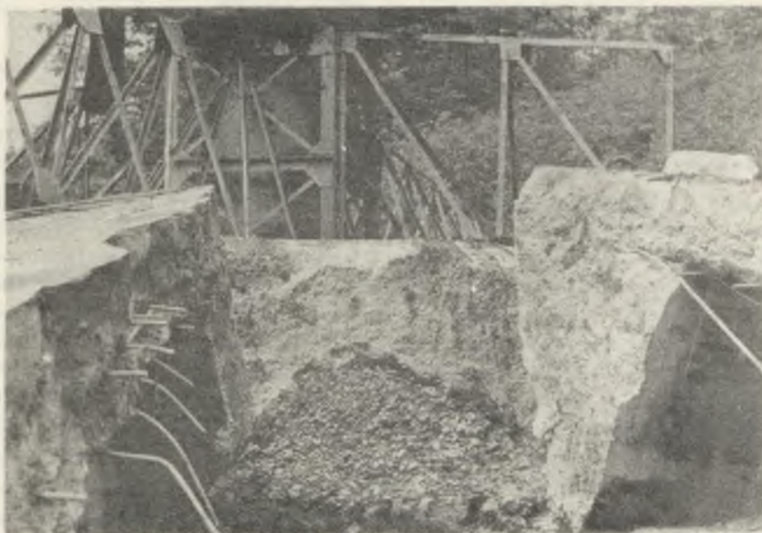
Rys. 5. Wadliwa partia betonu - wewnątrz trzonu fundamentowego
