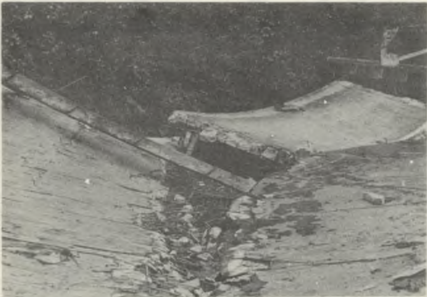
Rys. 4. Widok fragmentu zniszczonej ściany i dna
