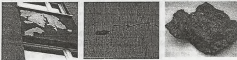
Rys. 1. Uszkodzenia układów ocieplających: a) odspojenia, b) zarysowania tynków, c) sole kalcytu w strefie stykowej
