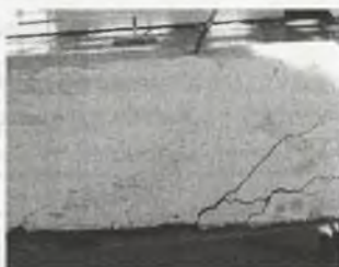
Rys. 3. Stopień uszkodzenia DW4 – zniszczenie belki w wyniku odspojenia taśmy wzmacniającej Fig. 3. State DW4 – failure of RC beam strengthened with CFRP
