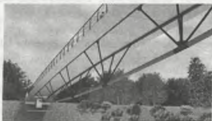
Fig. 2. External prestressing cables under the deck Rys. 2. Zewnętrzne kable sprężające pod płytą
