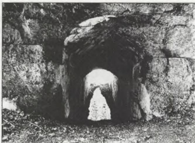
Rys. 2. Korozja ługująca betonu wejścia do schronu głównego w forcie IX „Ujkowice”. Widoczne skruszenia i łuszczenia się warstwy przypowierzchniowej na skutek działania wody opadowej [1]
