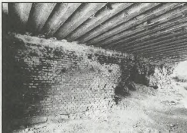
Rys. 1. Fort II „Jaksmanice”. Przelotnia łącząca koszary szyjowe ze schronem głównym. Wnętrze – widok w kierunku schronu głównego. Mur zaatakowany przez plechy o formach krzaczkowatych i listkowych. Widoczne ubytki muru spowodowane są parciem zasyпки. Na czole muru widoczna korozja lica ceramicznego [1]
