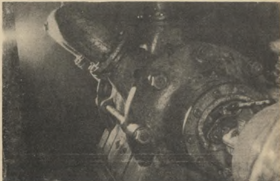
Rys.10. Pompa wirowa WWB 200 w czasie badań w kopalni - - widok od strony przewodu obiegowego
