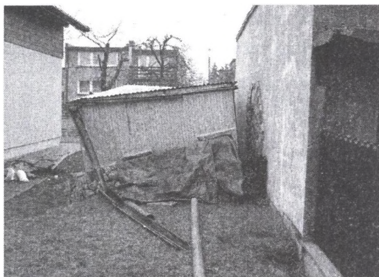
Rys. 3. Widok uszkodzonego garażu Fig. 3. View of the damaged garage
